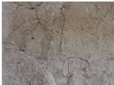
OVAN. ETT GRUNT HÅL I VÄNSTRA KANTEN BLOTTLÄGGER DEN UNDERLIGGANDE UTSTOCKNINGEN. SÅDANA HÅL FÖRSLÖTS I NEDERKANTEN MEN LÄMNADES ÖPPNA UPTILL.
