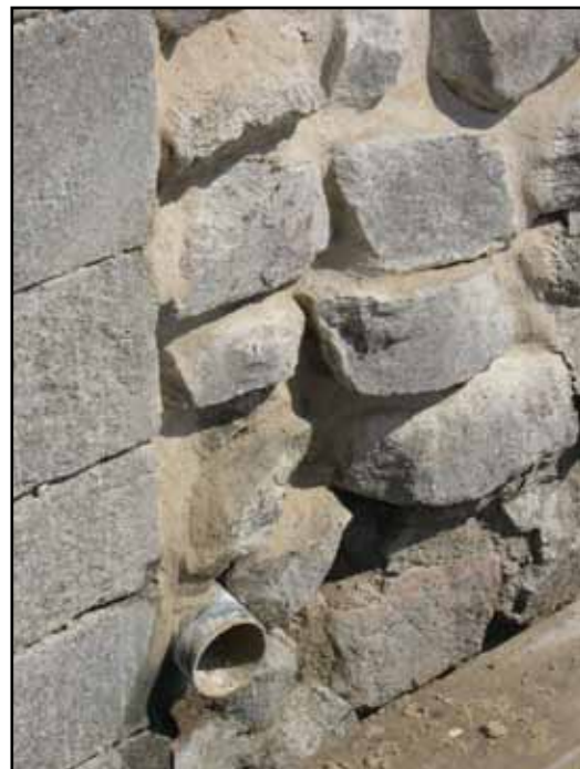
Dräneringsrör av segjärn inlagt i mötet mellan södra borggårdsmuren och huvudbyggnaden.
