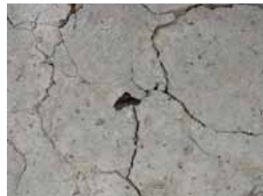
OVAN TILL HÖGER. SMÅHÅL UPPSTÅR VID PÅFRESTNING AV VÄDER OCH VIND I SPRICKORNA. STABILITETEN FÖRBÄTTRADES GENOM ATT DESSA HÅL I VISS UTSTRÄCKNING LAGADES.
