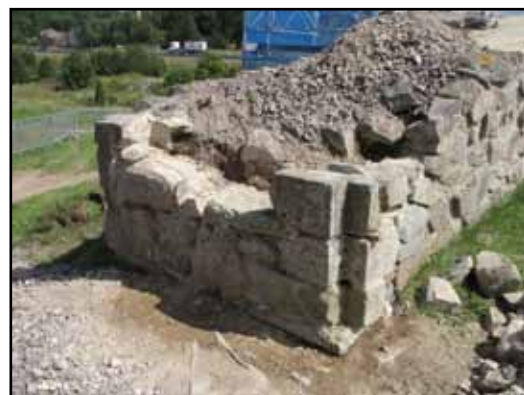
Östra sidan av portomfattningen till borggårdsentrén murades om på grund av en sättning.
