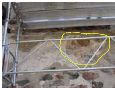
OVAN. I INRE SYDÖSTRA HÖRNET HADE PUTSEN SÅ DÅLIG VIDHÅFTNING ATT DEN DELVIS RASADE NER INNAN KONSERVERINGSARBETET HADE PÅBÖRJATS. SE MARKERAT PARTI I BILDEN.
