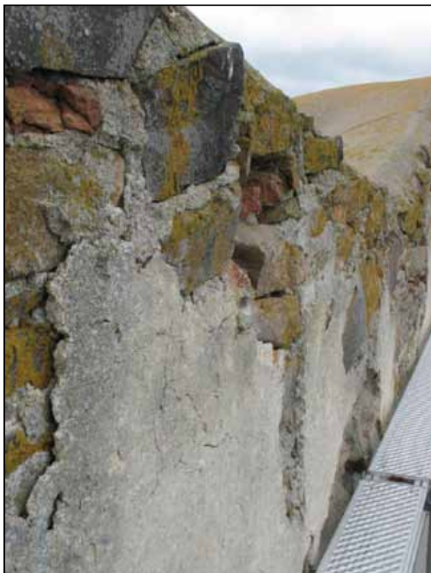
Skadad putskant på nordfasadens krön före åtgärd. Hög risk för frostsprängningar och nedfall.
