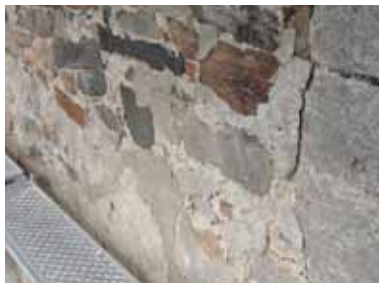
OVAN TILL VÄNSTER. DEN LJUSA ORIGINALPUTSEN LIGGER DELVIS DOLD BAKOM SENTIDA GRÅAKTIG RESTAURERINGSPUTS. RESTAURERINGSPUTSEN ÄR STABIL MEDAN DEN SVAGARE HISTORISKA FORTSÄTTER ATT BRYTAS NED.
