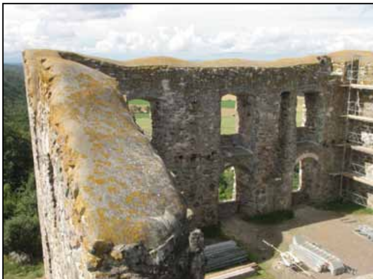
Huvudbyggnadens krönavtäckningar tillkom 1984-1985 och utgörs av cementbruk på gummiassfalt. Dessa är i gott skick så när som på några sprickor, exempelvis i nordöstra hörnet, se bild till höger.
