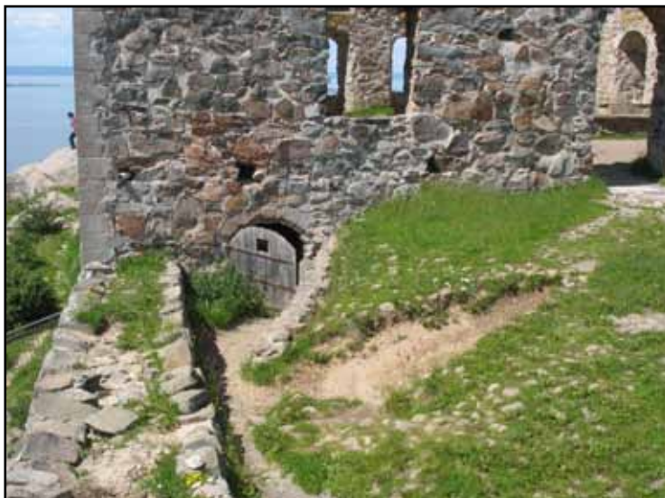
Sydvästra hörnet av borggården före arbetena. Södra borggårdsmuren har en nedbruten murkärna i sin övre del och saknar avtäckning. Stenläggningen är bitvis bortspolad och kullerstenar har försvunnit.
