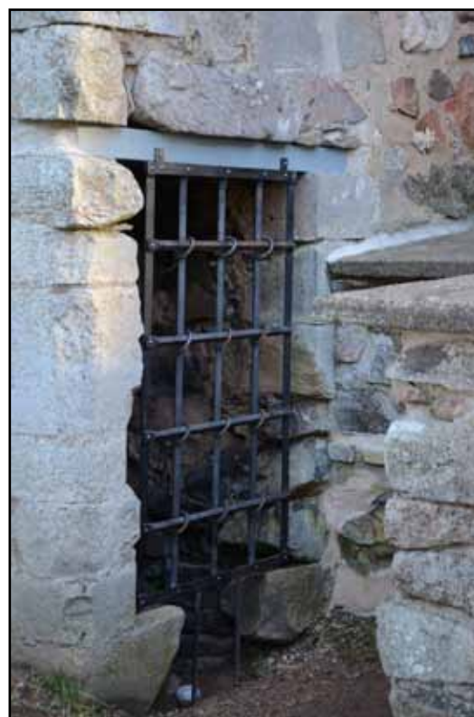
Smidesgaller till källare, södra tornet och två muröppningar i norra muren.
