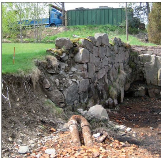
FIGUR 11. Samma vägg ett år senare. Större stenar har rasat ner och blottlagt murkärnan varpå ytterligare ras riskeras om inget görs.
