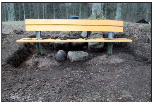
FIGUR 4 OCH 5. Ett ca 4,5 m stort schakt grävdes runt parkbänken för att dokumentera skadan.
