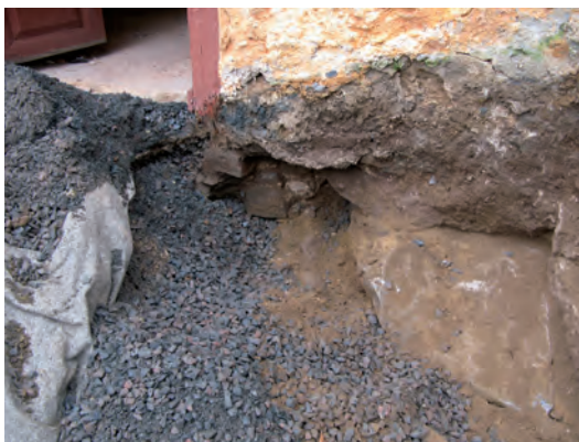
FIGUR 13. Sår i murverket efter den bortbrutna trapphällen vid ingången på souterrängvåningens södra gavel. Foto: Claes Pettersson, JLM.
