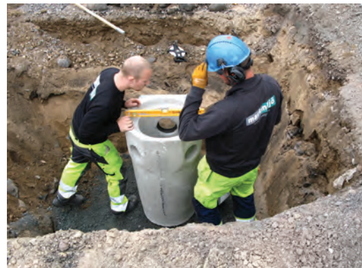
FIGUR 6. Utplacering av dagvattenbrunn intill Riksbyggens nya fastighet. Foto 2016: Claes Pettersson, JLM.
