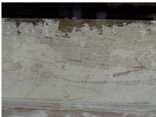
Skrapad takfot, de tidigare färgskikten framträder.
