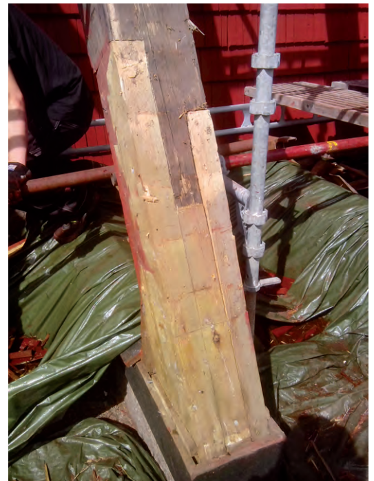
Ett av stödbenen åt söder, var sedan tidigare lagat. Foto: Hälsinge Takspån.
