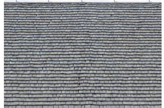
Södra takfallet före, vissa skadade spån gick att uppfatta från mark.
