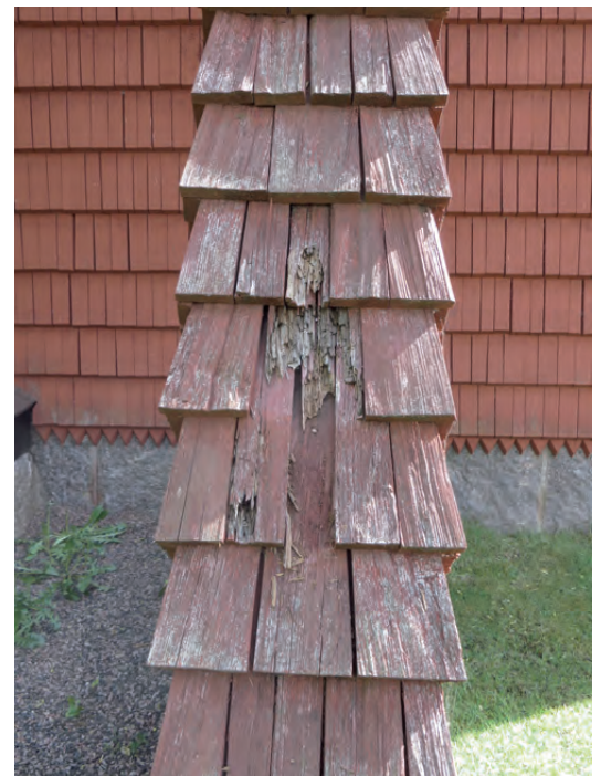
Rötskadade spån på stödbenen på kyrkans norra sida.
