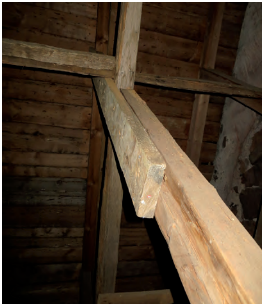
Ovan: En sparre över koret förstärkt på ena sidan. Ovan till höger: Ett remstycke över koret förstärkt med ett plattjärn.
