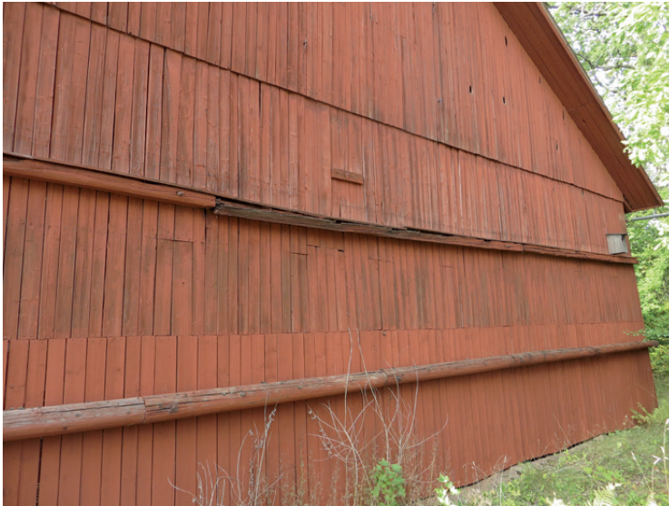
Den övre gördellisten på kolladans östra gavel var partiellt rötskadad.
