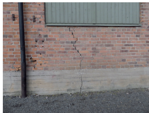
En spricka i kärnmakeriets östra fasaden noterades under ett av fönstren.
