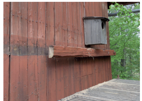
Den rötskadade delen av bjälken är bortkapad.
