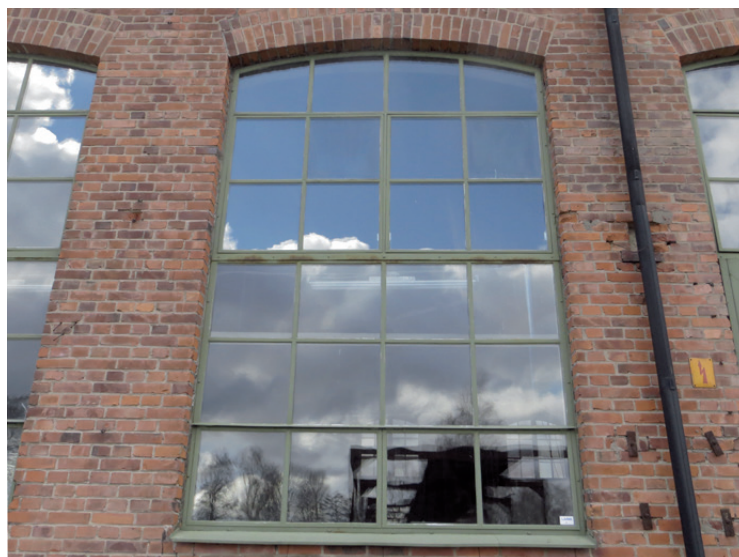
Gjutjärnsfönstren i kärnmakeriets östra fasad var delvis rostiga och i behov av ommålning.
