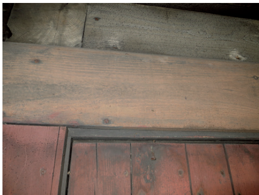
Färgspår och jämförelse mot färglikare på lanterninens fasad och takfot.
