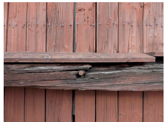
Detaljbild av rötskadad gördellist.
