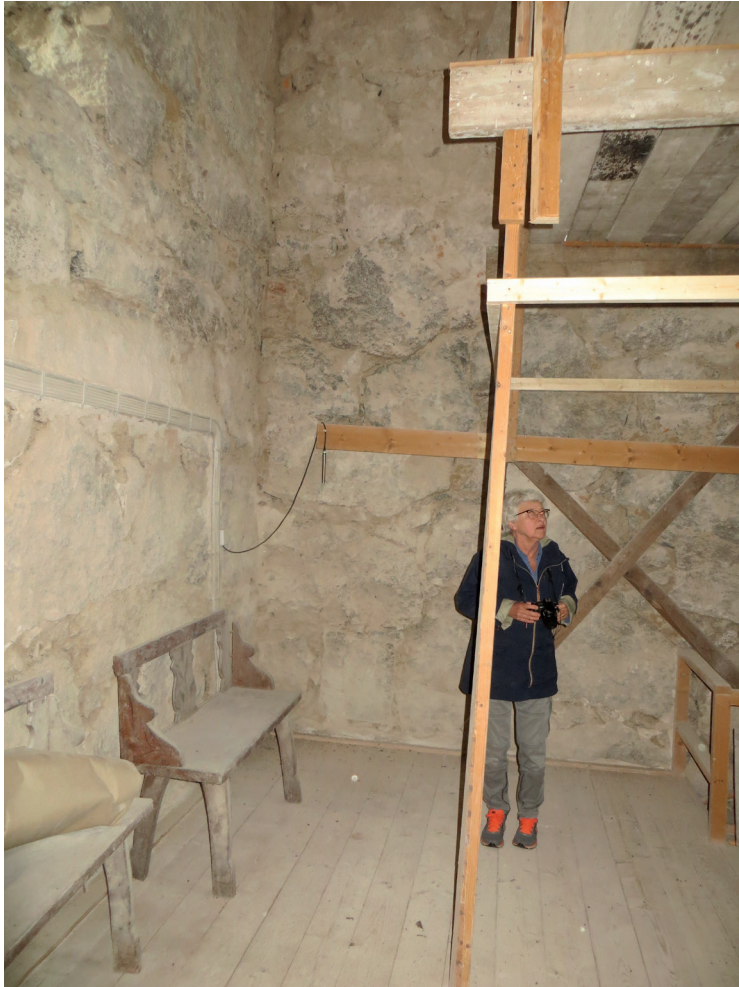
Bygglédare Ann-Marie Dahlin, ATRIO arkitekter Väster- vik AB, inspekterar tornutrymmet som nu befriats från skadad puts.
