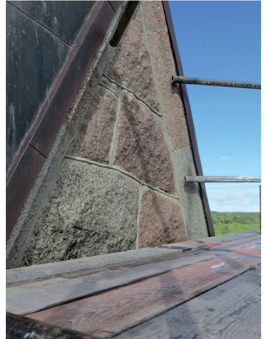
Ovan: Gavelspets upptill på tornet med nya åsfogar. Ovan till vänster: De nedre delarna av tornet och långhuset vid slutbesiktningen. Vid tornets hörn syns ett av de nya stuprören.
