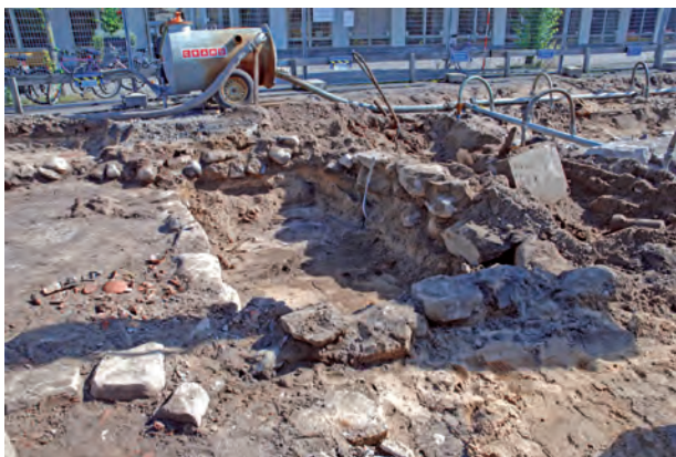
FIGUR 89. Bassänggrund. En lokal lösning på problem med markfukt?
