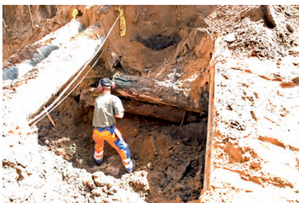
FIGUR 83. Timmerkista ute i Slottsgatan – det sammanstörtade kanalschaktet.
