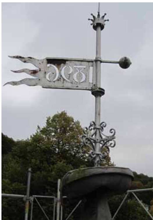
Vindflöjeln på den sydöstra tornet hade förlorat sin invändiga infästning och glidit ned. Samtidigt hade plåtklotet som tidigare suttit mitt på den nedre delen av staget åkt ned och deformerats.
