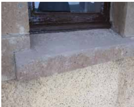
Exempel på lagad solbänk av kalksten.
