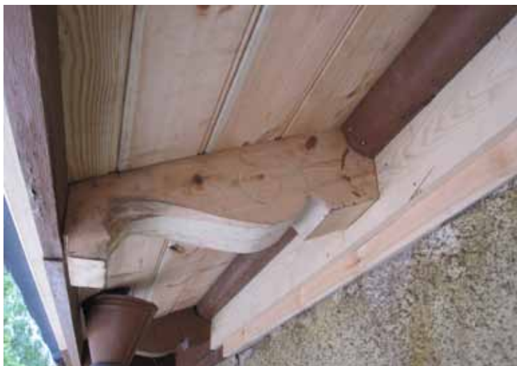
Skadorna i undertaket var i huvudsak orienterade till takfotsutsprången. Flera löpmeter av pärlspåntpanelen och ett tiotal taktassar fick bytas ut. Här ett åtgärdat parti i det östra takfallet.
