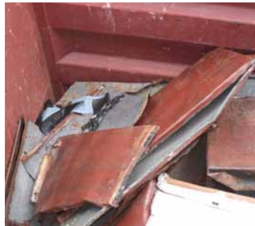
Vid rivningen framkom att man använt varmförzinkad plåt, vilken var en nymodighet på 1890-talet. Dessutom hade denna mer beständiga plåttyp föreläggning strukits med täckande järnoxidröd oljefärg på både fram- och baksidan.
