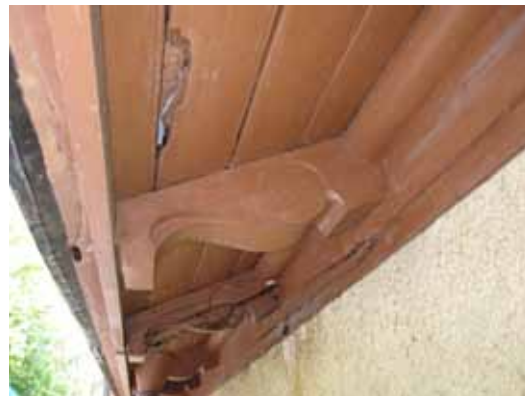
Läckage i plåttaket hade orsakat rötskador i takfotens taktassar och pärlspåntpanel.
