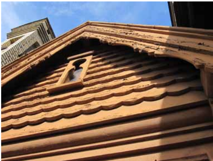
Takkupornas gavlar var klädda med dekorsågade lister som liknar fjällpanel. I utsatta lägen krackelerade färgen kraftigt.
