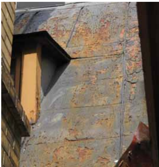
Takfärgen är kraftigt nedbruten och den tätgummaktiga färgen hade hållit kvar fukt och därigenom påskyndat skadeförloppet.
