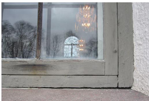
Träbågarna hade tidstypisk spårfals. I vissa lägen hade dessa sekundär ersatts med kittfals med plastbaserat kitt.
