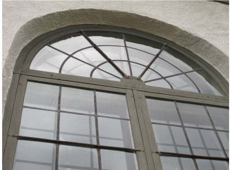
Blyinfattningen har både invändiga och utvändiga stormstag i smide. Stagen hade kvar originalinfästningen med smidd spik. Utvändigt var de kraftigt rostangipna.
