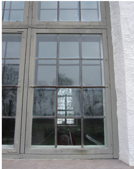
Blyspröjsen var sammansatt av två blylister med U-profil. Blynätet saknade kittning.
