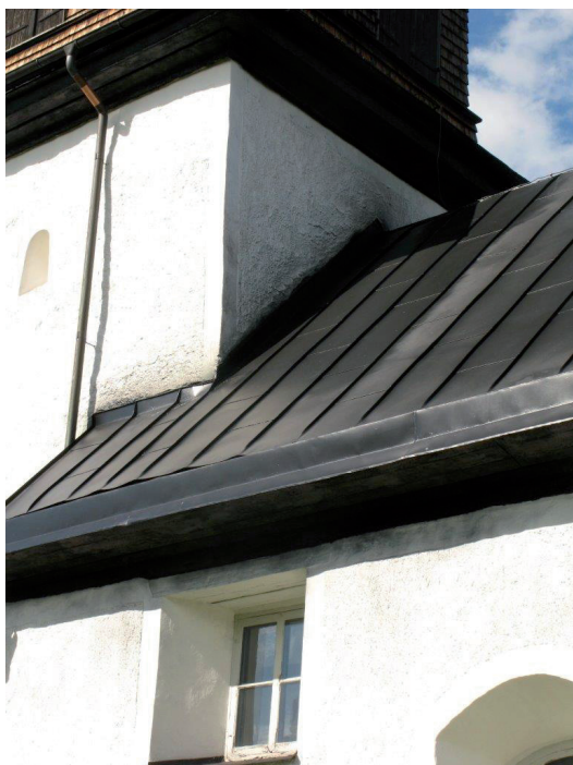
Takfärgen sprutades och orsakade därvid kraftiga fläckningar av anslutande fasadpartier.
