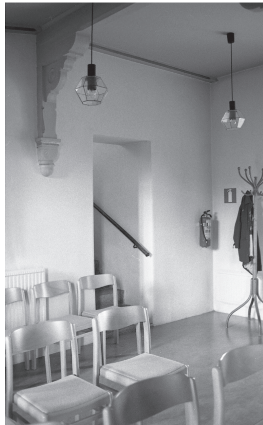
Trapploppet upp till läktaren före åtgärd.
