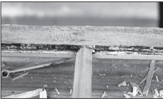
Blyspröjsen var i många lägen försvagad av oxidation och fick ersättas.
