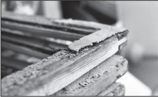
Hörnbeslagen hade i många lägen lossnat och tryckts ut till följd av rost på baksidan.
