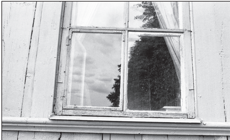
Enstaka vädringrutor finns i den norra pochens fönster.
