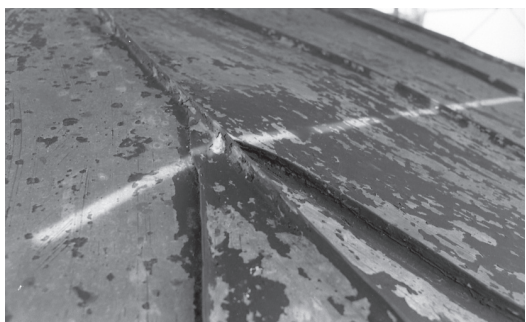
Lanterninens plåttak var i stort behov av ommålning.
