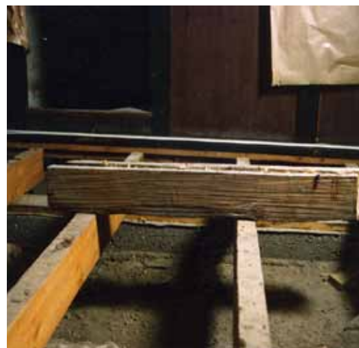
En ca 1 meter lång del kapades av i syllens östligaste del. Notera dess fullkantsbilade skubbhyvlade yta. På andra sidan av syllen fanns en handhyvlat fotlist med fasad överkant (se bild sidan 38). Foto: Göran Sandstedt.
