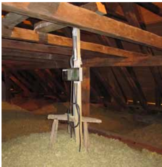
Det samplade brandlarmet genom kyrkorummet valv drogs på kyrkovinden.
