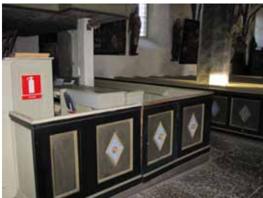
En ny estetiskt välanpassad manöverpanel byggdes i det nordvästra bänkkvarteret.
