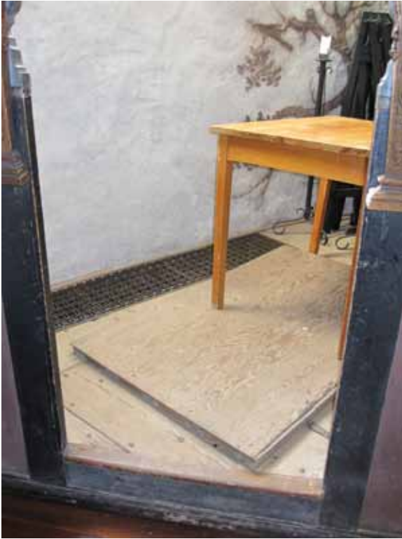
Det nya tillluftsdonet i den södra korsakristian.
