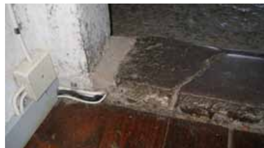
I tröskeln av rödbrun kalksten mot sakristian fanns en missprydande cementlagning som gjorts i samband med sentida elkabelgenomföring.
