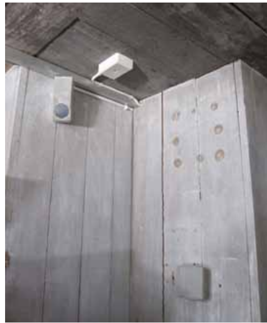
Fukt- och temperaturgivaren samt rörelsedetektorn på orgelhusets vägg, diskret målade i väggytans kulör.
