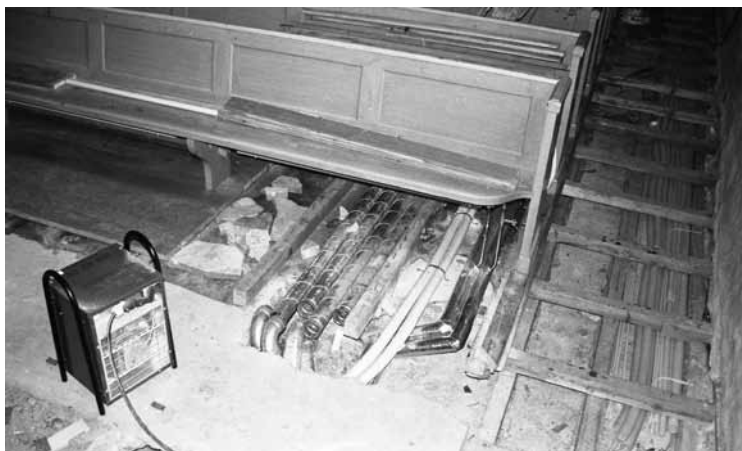
Ledningsschakt förlades till bänkkvarterens sockelutrymmen och i sidogångarnas golv.
