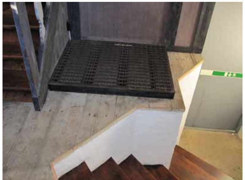
Det nya frånluftsdonet i den norra korsakristian. Luftdonet med kanal är försänkt i golvet samt täckt med golvgaller i specialbehandlat stål.
