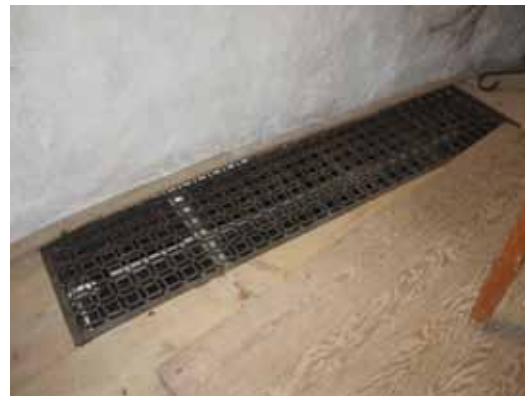
Detalj av det nya varmluftsdonet i södra korsakristian. Golvgallren gavs samma utseende som befintliga gjutjärnsgaller i främre tvärgången. Av ekonomiska skäl utfördes de istället av laserskuret stål. Gallren föroxi-derades genom behandling med saltsyra och förvaring utomhus för att få en liknande yta som gjutgodset.
