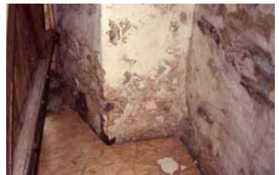
En omfattande skada med saltvittrad puts fanns i vapenhusets norra vägg.
