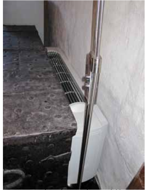
Den nya värmekonvektorn i sakristian doldes genom att placera järnkistan som tidigare fanns på Braheläk-taren här.
