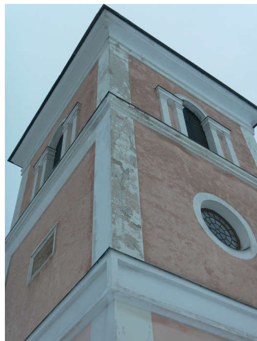
De slätputsade hörnpilastrarna på tornets övre del hade omfattande putsskador. Foto: Rose Bergstöms & son AB.
