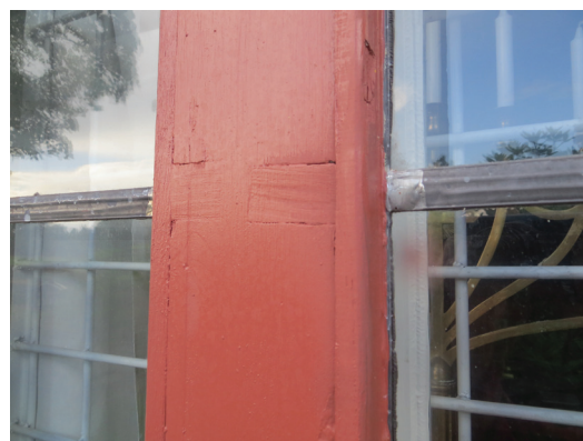
Där blyspröjsarna ansluter mot sakristiands fönsterbåge finns spår efter lagningar, som är svårförklarliga.
