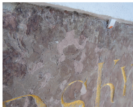
Lagningar av skador i inskriptionstavna i kalksten på tornfasaden.
