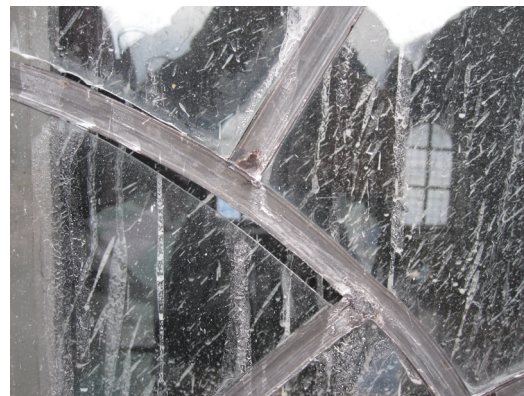
Rutorna i långhusets fönster hade i vissa lägen glidit ur blyspröjsen.
