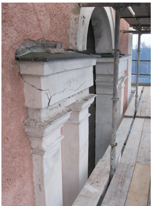
På ljudluckornas putsomfattning fanns kraftiga sprickbildningar orsakade av korrosionangrepp på järnkramlor i murverket. Kramlorna frilades och behandlades med blymönja som rostskydd.
