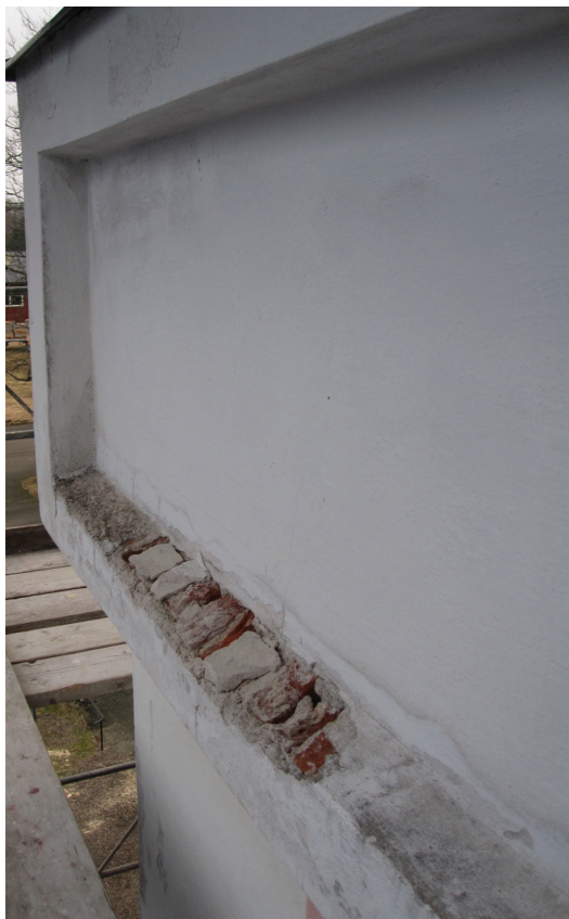
Den nedre delen av gördelgesimserna på tornet hade frostsador och försågs därför med en plåtavtäckning.
