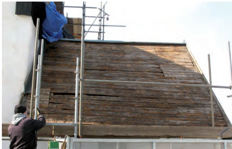
Östsidan av sakristians undertak före reparation. Till största delen bilat virke fäst med smidd spik, dock i dålig kondition.
