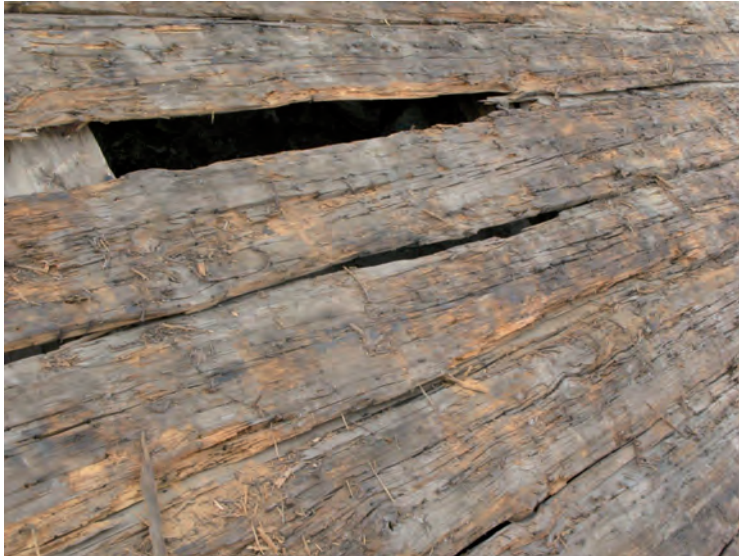
Äldre undertak av bilade brädor på sakristian.
