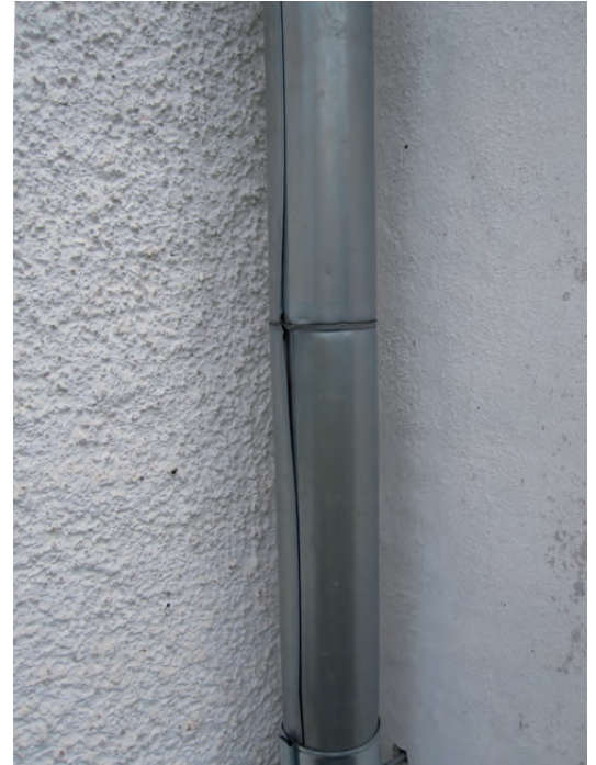
Några av stuprören hade skador av frostsprängning.
