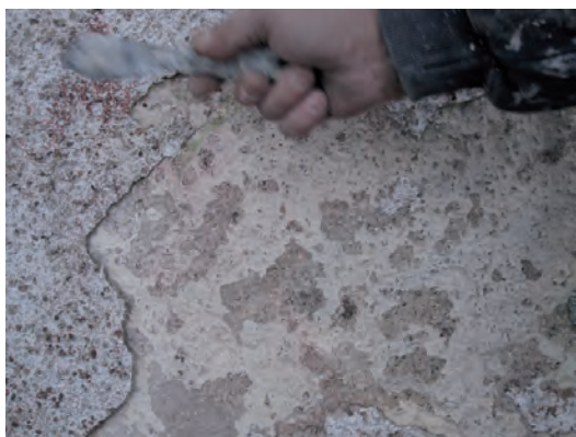
Enstaka partier av spritputs med bom knackades ned.
