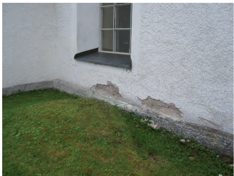
På norra fasaden var det ett parti med skador, troligen relaterat till fukt och stänk på fasaden från den bergknalle som går högt i dagen i direkt anslutning till sockeln.
