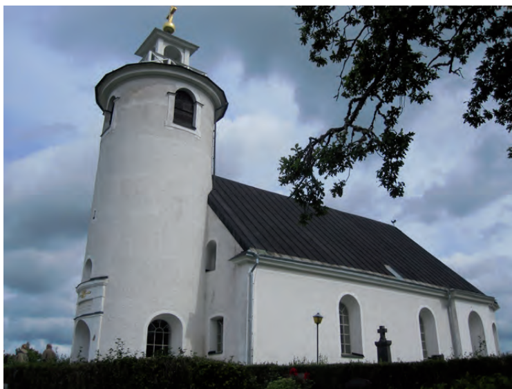
Ökna kyrka från sydväst före åtgärd. Bomlagen från tidigare avfärgning framträder tydligt på tornet.
