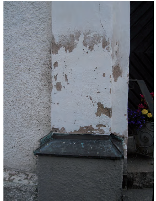
De nedre partierna av portalens omfattning var bättringsmålade med en olämplig färgtyp.
