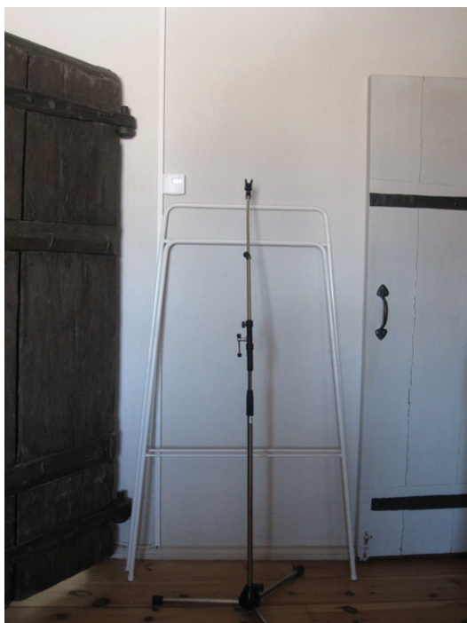
Givaren i sakristian är placerad bakom porten in till kyrkorummet, kabelkanalen var dragen sedan tidigare för annan installation.
