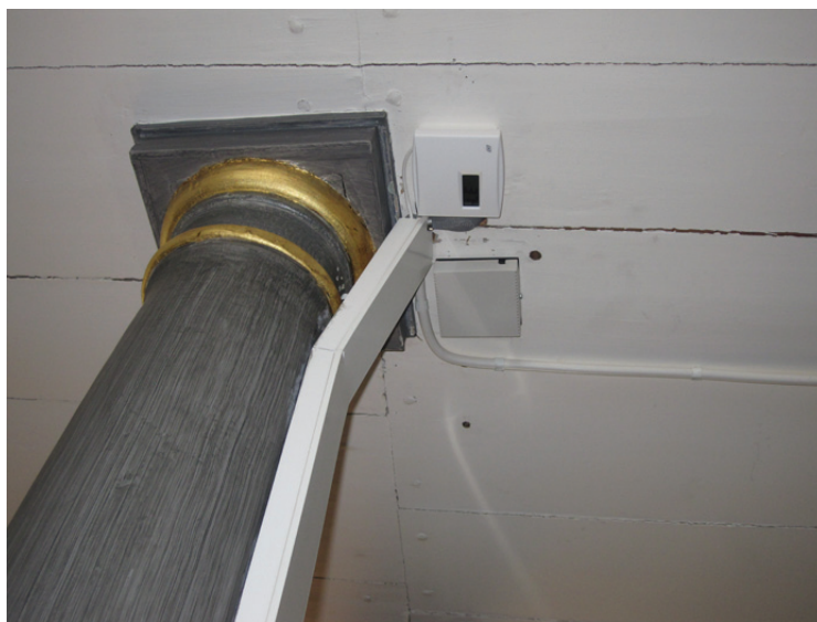
Givaren under läktaren är monterad i taket. Kabelkanalen på kolonnen är från tidigare installation. Kanalen ska målas in för att blir mindre iögonfallande.
