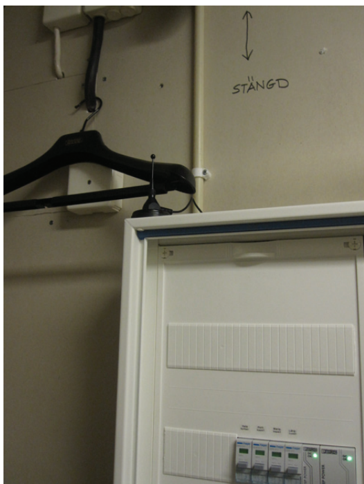
Den nya styrenheten är placerad i anslutning till elcentralen. En sändare för de trådlösa givarna står ovanpå skåpet.
