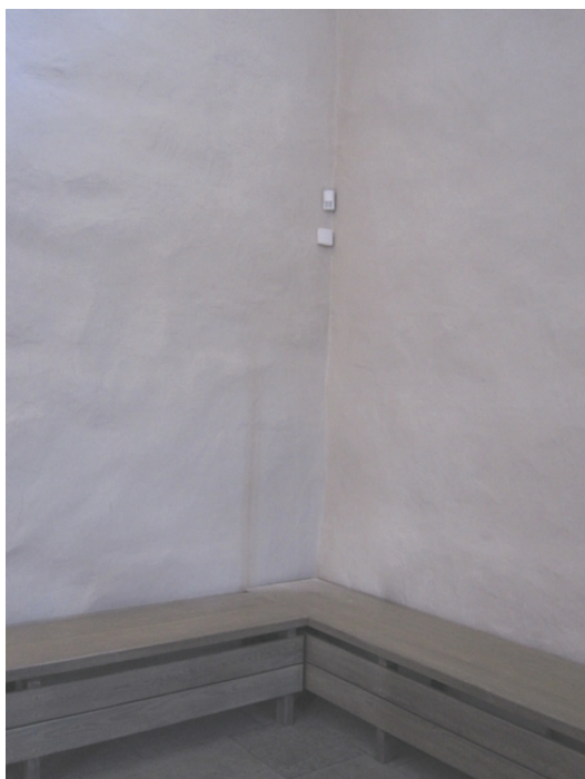
Givaren i norra korsarmen, är placerad i anslutning till tidigare monterat larmdon.
