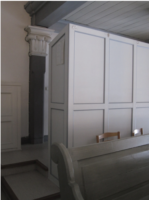
Skåp på orgelläktaren, före utförd installation.
