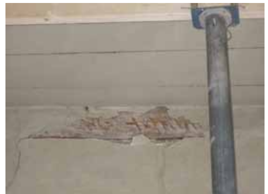
Ett problem generellt var att träkonstruktioner låg inmurade i murverket. Detta medförde dels att träet tog upp fukt, dels att trädelarna var svårinspekterades. Bilden visar en träbalk som täckts med puts.
