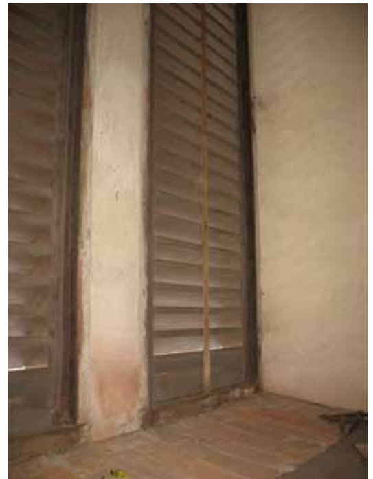
En av anledningarna till de höga fukthalterna i tornet kan ha varit den konstruktion med ventilerande jalousier som funnits i ett tiotal år. När varm, fuktig luft kommer in och kyls av i tornet kondenseras fukten. Problemen med fukten åtgärdades genom att täta tornet och avfukta luften.
