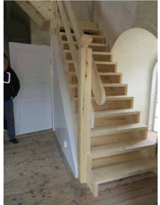
Den nya trappan i tornet utfördes omsorgsfullt med bland annat mäklare med krönornament, vars förebild fanns i vapenhuset. Här där det skulle skapas en klimatgräns ner mot vapenhuset fick trappan byggas in.
