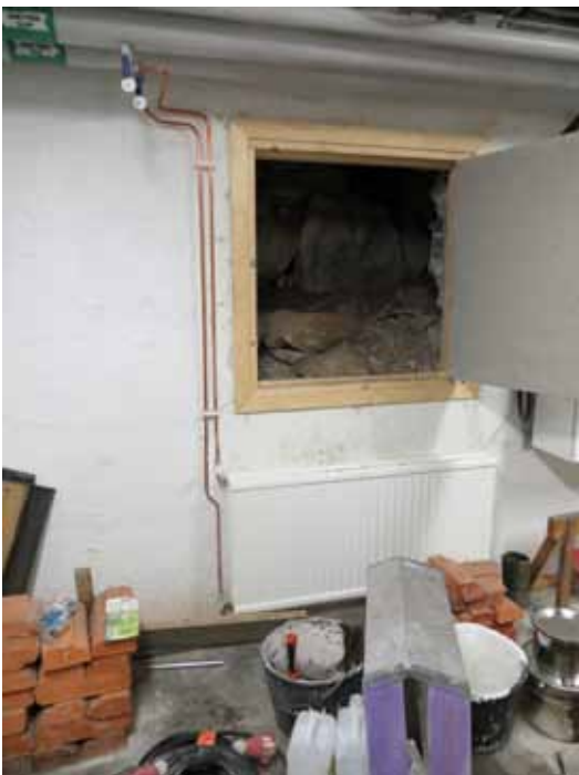
Tillträdet till krypgrunden hade försäkrats av att luckan var liten. Bilden visar den nya öppningen som togs upp i pannrummet.
