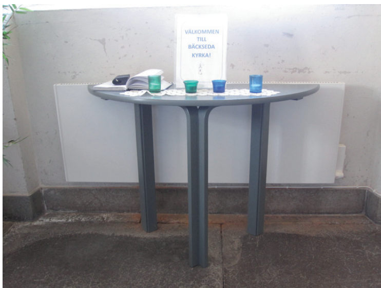
Ovan: den nya elradiatorn i vapenhuset placerades under fönstret i väster.
