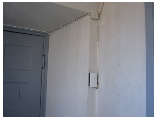
Elradiatorn i vapenhuset styrs av en trådbunden givare. Den placerades i en nisch på muren mellan entrédörren och dörren in till kyrkorummet.
