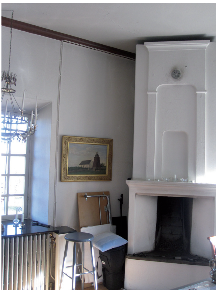
Kompletterande kabeldragning i sakristian. Kablarna på list ska målas in mot listen, detta var ej utfört vid slutbesiktningen.
