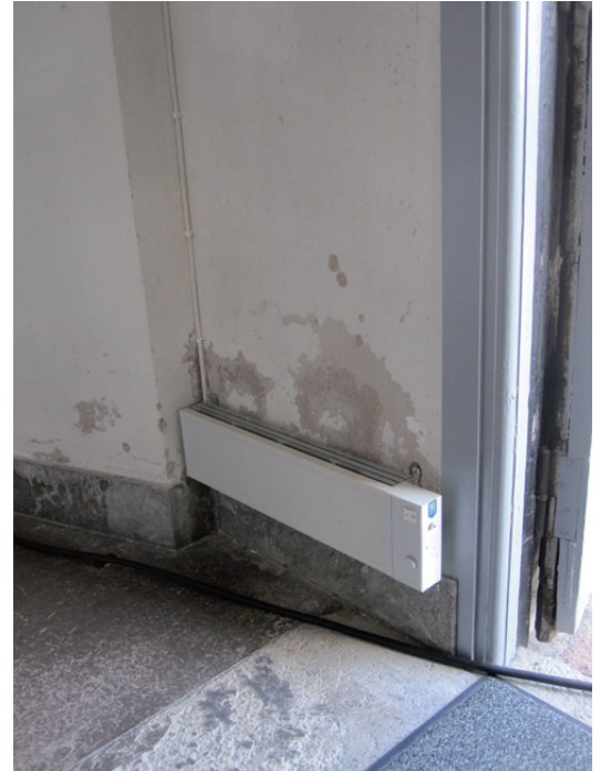
Ovan: den tidigare elradiatorn i vapenhuset. Ovan till vänster: sakristian före installation.
