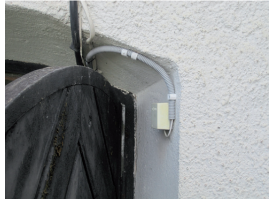
Tidigare utomhusgivare var placerad i samma läge, i dörrnischen in till pannrummet.
