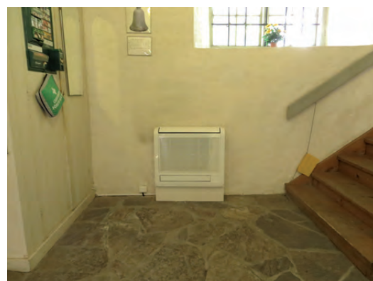
Ovan: konvektorn i vapenhuset. Den svarta kabeln från eldosan ska målas, vidare återstod viss rengöring av tidigare nedsotad mur.
