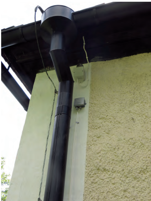
Utomhusgivaren monterades på sakristians norra sida, i anslutning till stupröret. Vid slutbesiktningen återstod inmålning.
