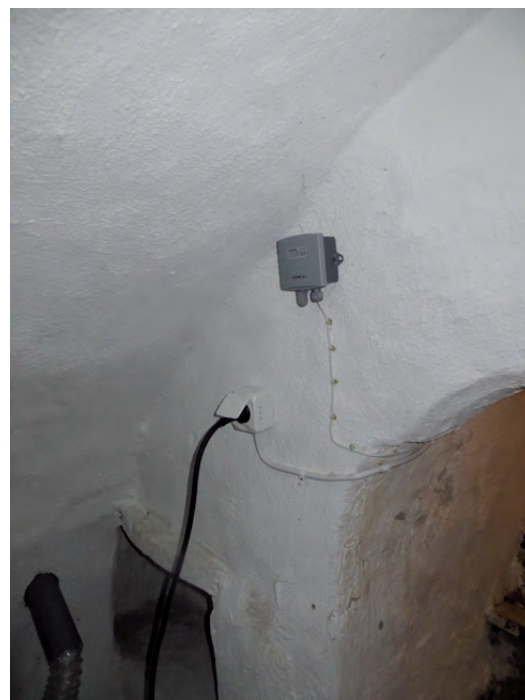
Klimatgivare i källarutrymmet under sakristian.
