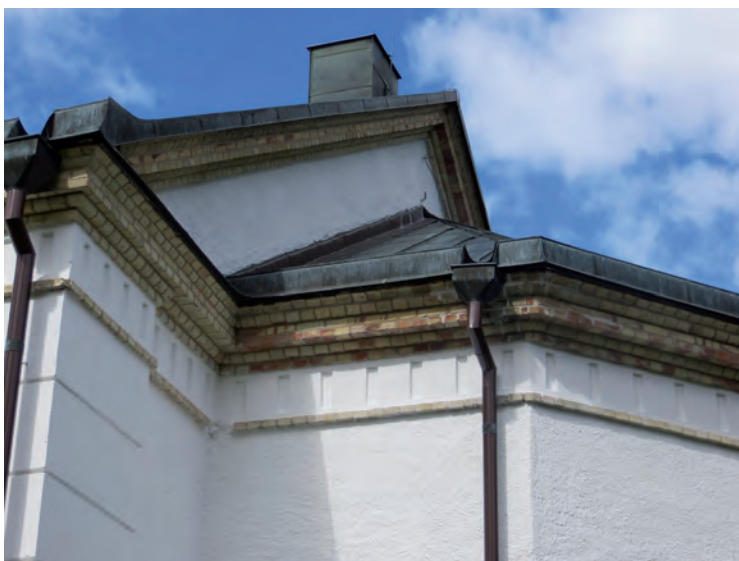
Korets tegelgesims fick fogas om närmast stuprörstrattarna.
