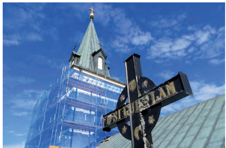
Korset över sydingången hade bristfällig målning och förgyllning. Detta åtgärdades.
