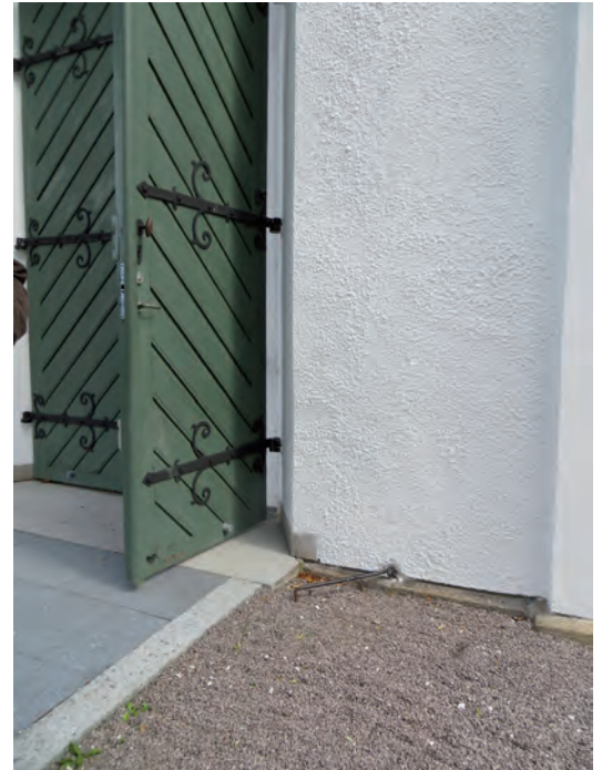
Ovan: Vid slutbesiktningen beslutades att dörrstoppar och dörrhaspar skulle förlängas för att undvika skador i nischputsen.
