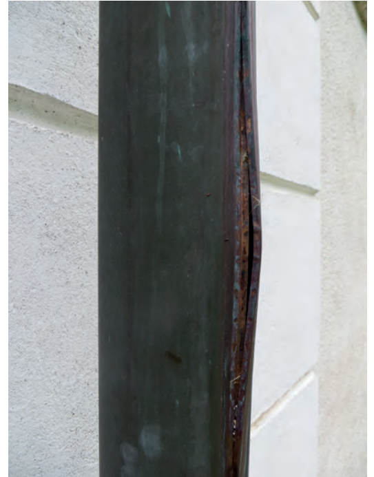
Ovan: Alla stuprör var mer eller mindre skadade och spruckna efter frostsprängning.
