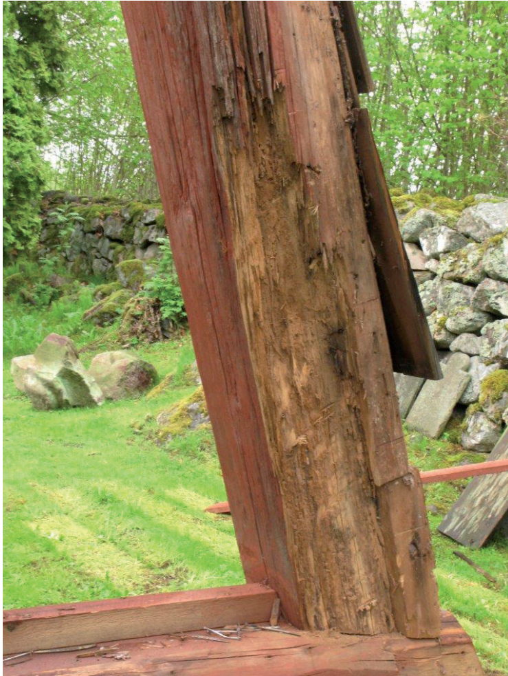
Rötskada på östra stödbenet.
