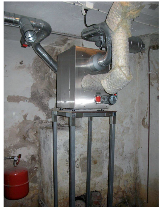
Sorptionsavfuktaren på sitt stativ i pannrummet, på platsen för den gamla pannan.
