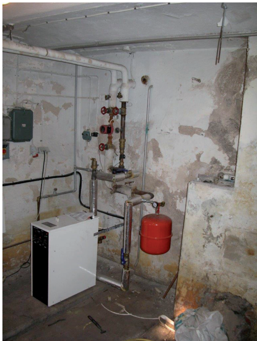
Pannrummet från 1936 med dagens elpanna. Till höger läget för den gamla vedeldade pannan.
