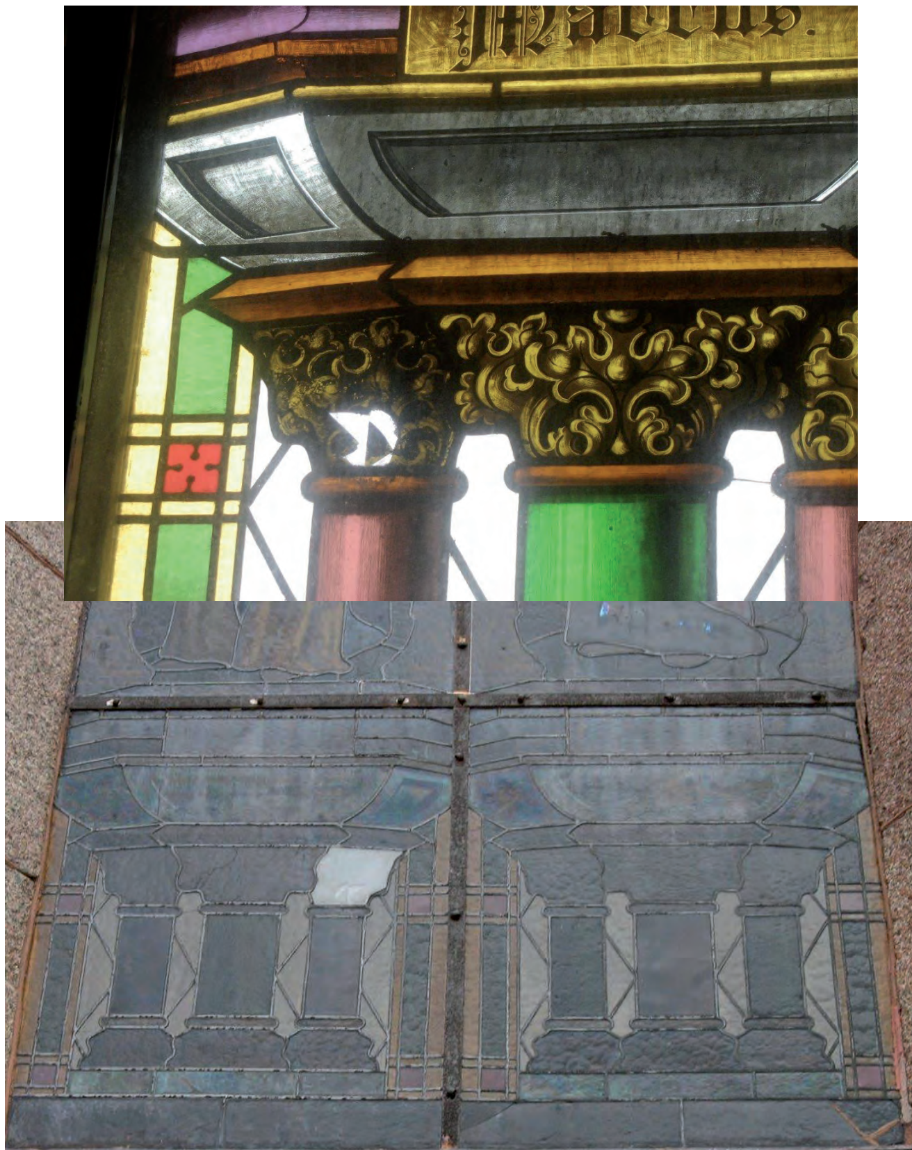
Nordöstra absidfönstrets båda nedre lufter ("Marcus" och "Mattheus") före restaurering. Bladkapitalet på en av kolonnerna ("Marcus") är skadat med materialförlust. Rutan har lagats med pålimmat enkelt glas.
