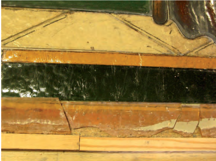
Trasiga kantlistgals på "Lucas". Infogningen med cement har skadat glaset och försvårade demonteringen.
