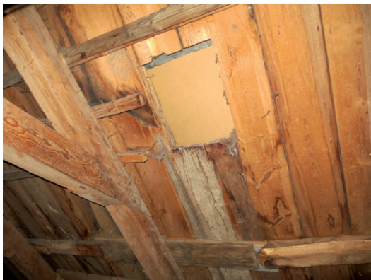
Det igensatta takfönstret inifrån vinden.
