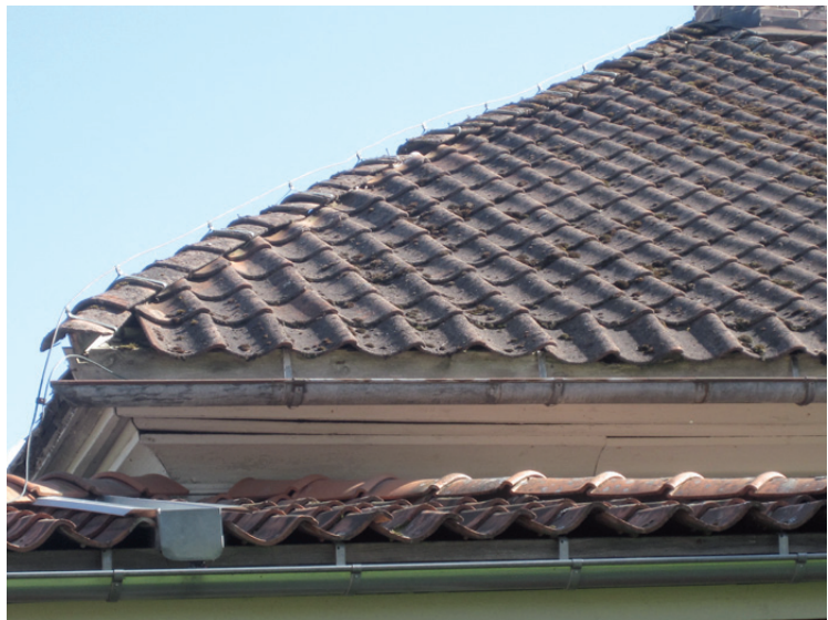
Detalj av norra takfallet före åtgärd. Den nedersta raden av takpannor ligger inte i liv med taket i övrigt, vilket indikerar att det finns skador i undertaket.
