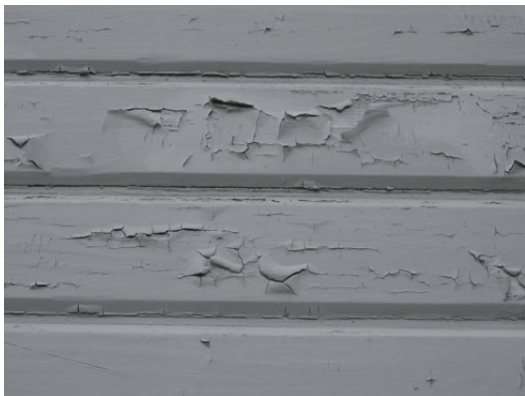
Den liggande panelen mot söder uppvisade generellt mycket blåsbildningar och färgen flagnade kraftigt.
