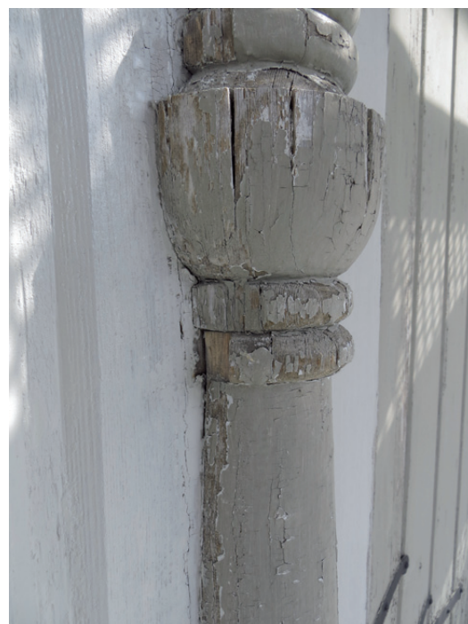
Dekorative trädetaljer hade vissa torrsprickor men inga röttskador. I några fall hade smärre delar fallit ur, dessa ersattes ej.
