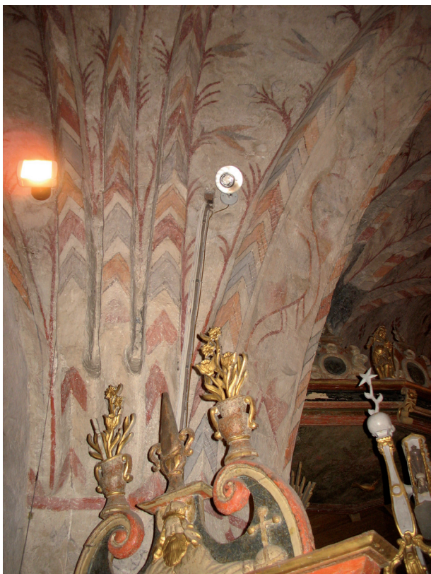
Exempel på befintlig korbelysning i triumfbågsvalvet med bland annat bygglampa och vanprydnade kabeldragningar.
