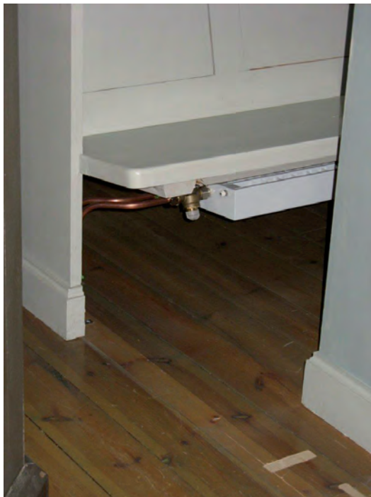
Nya vattenburna konvektorer under bänkarna.
