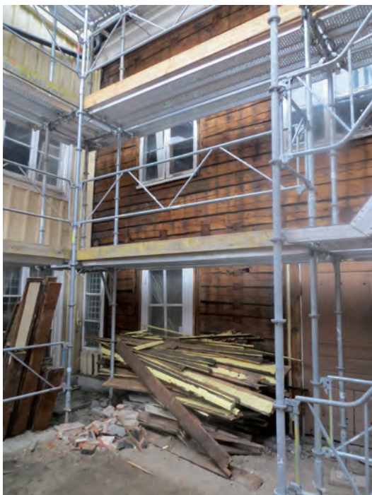
Smedjegatan 11, gårdsfasad. Här har panelen börjat demonteras på gårdslängan utefter den västra tomtgränsen. Timret har aldrig varit rödfärgat.
