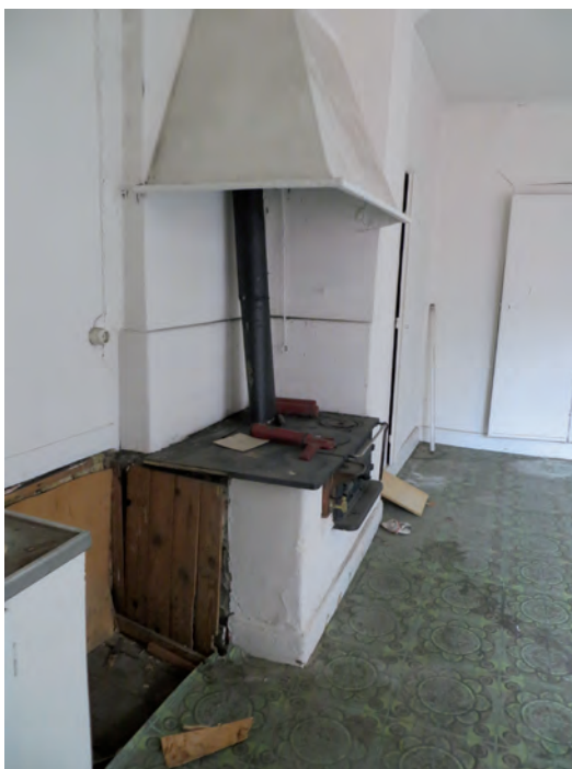
Smedjegatan 11, rum 117. Köksspisens med kåpa av stålplåt.
