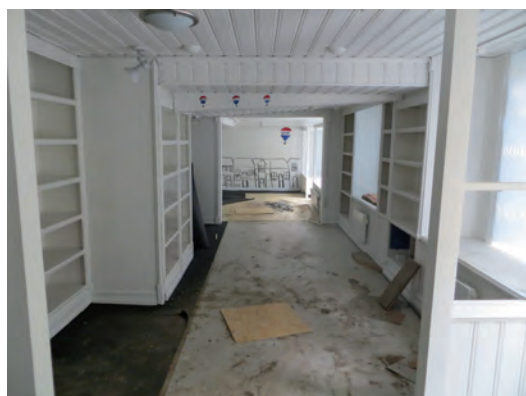
De båda byggnaderna på nedre plan hade ursprungligen bestått av närmre tio rumsenheter. Under 1900-talet hade mellanväggarna vid flera tillfällen sågats upp för att skapa en öppnare planlösning i butikslokalerna. Detta hade också gjort timmerstommen instabil.
