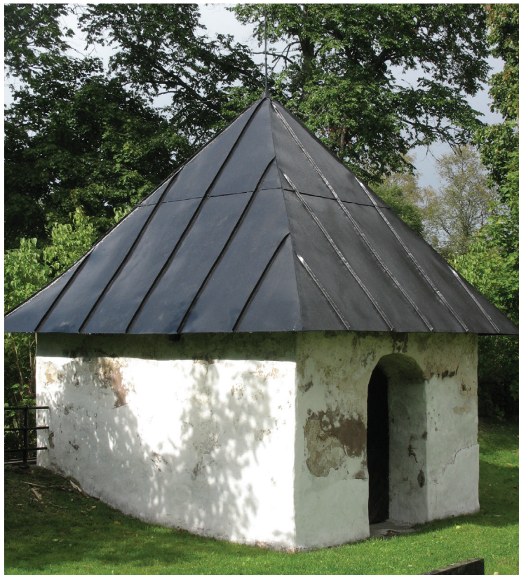
Gravkoret i september 2012. Taket ommålat med svart linoljefärg.
