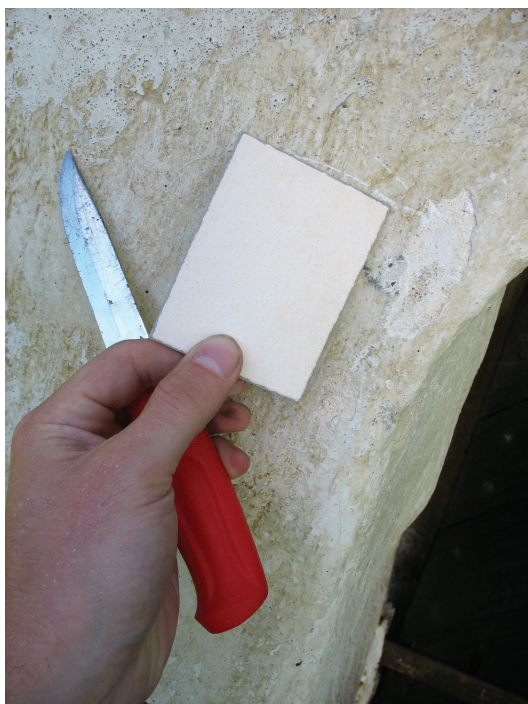
Äldre putsskikt uppvisar en pigmenterad kalkfärg, sannolikt med inblandning av järnvitriol.
