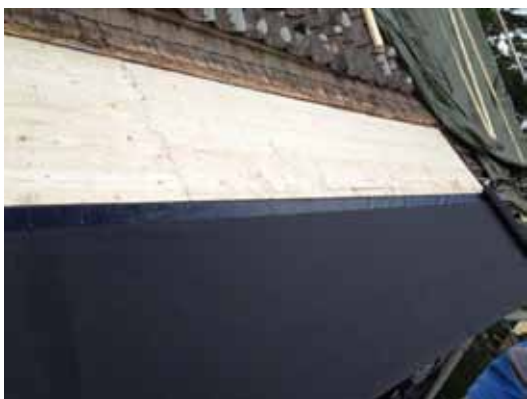
Takfotens brädor var kraftigt rötskadade och byttes, likaså var det behov att byta ut en del av undertaket med råspont. Ett nytt tätskikt lades på stickorna (Diviroll).
