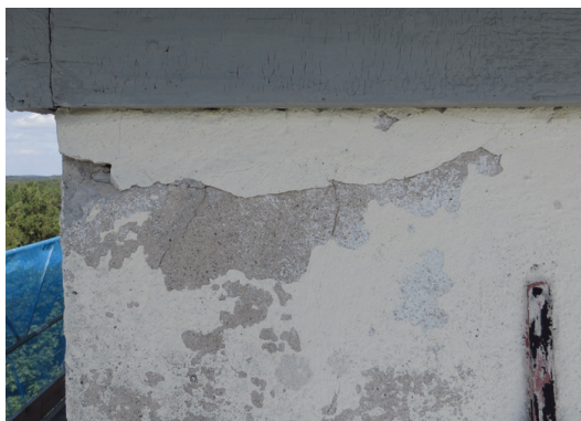
Ovan: Detalj putsskador i anslutning till lanterninen. Till höger: Kapellet hade stora fuktrosor och problem med fukt och saltutfällningar i framförallt sockeln.
