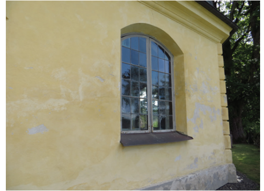
Kapellets avfärgning flagade, här fasaden mot nordväst.
