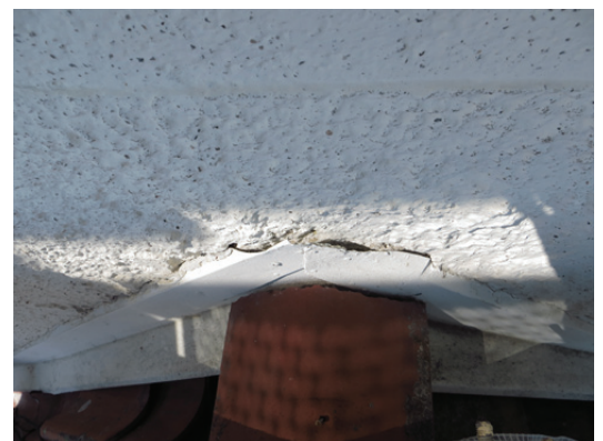
Plåtanslutningen mellan tornet och långhuset hade flera glipor, framförallt i nock.
