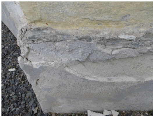
Kapellet hade putsskador dels på fasaden dels på sockeln. Här ett exempel från sydvästra hörnkedjan där putsen skittar sig efter påslagen och ramlar av.
