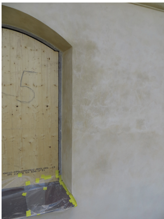
Kapellets fasad upplevdes som skäckig vid slutbesiktningen.
