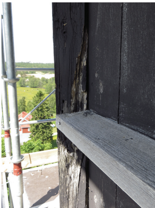
Två av lanterninens hörnplankor uppvisade rötskador och byttes.
