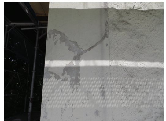
Putskada på det slätputsade hörnet.
