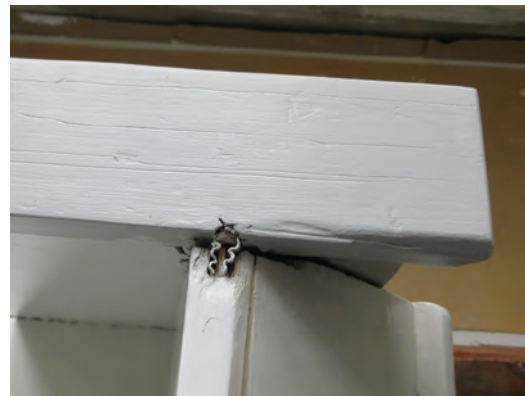
Vid 1970-talets renovering hade bänkdelarna lagats och stadgats med korrugerade bleck.
