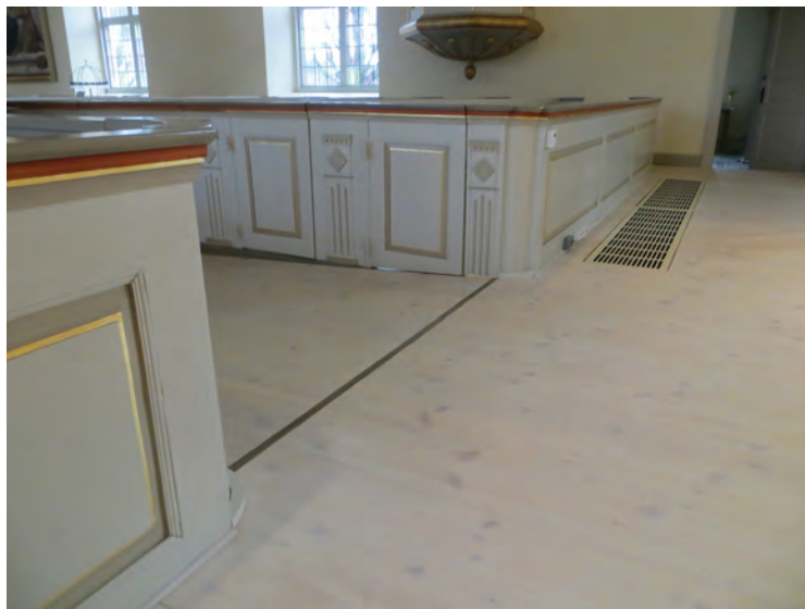
Bänkarna efter ommålningen. I golvet ses även den kontrastmarkering som visar var rampen börjar. Framför bänkskärmen ligger det nya gallret till konvektorgraven.
