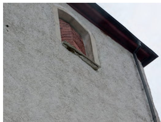
Parti av tornet där det framgår att topparna på spritputsens ballaststen saknar avfärgning.
