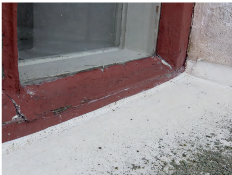
Detalj av fönster med ramstycke av trä, men spröjsverk av stål. Rötskador hade främst uppstått i bågbottnestyckena vid mötet mellan de två olika materialen.
