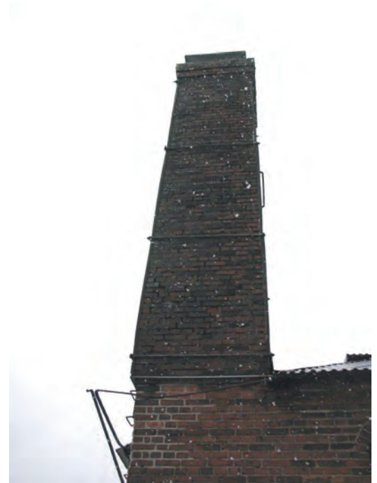
Skorstenen från söder. Notera plattjärnet och staget som burit ett mindre takfall runt skorstensbasen.
