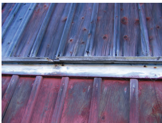
Detalj, skadad våningsbandlist.
