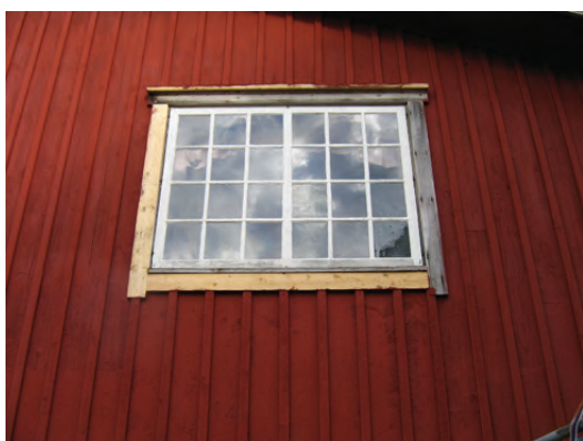
Detalj sågens södra fasaden, fodren på ett av fönstren var inte målade vid slutbesiktning.
