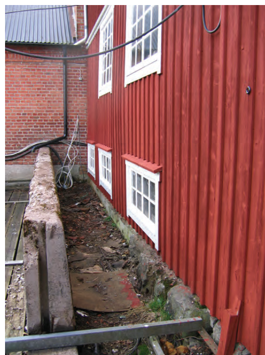
Sly och växtlighet har rensats bort från utrymmet mellan fasaden och den gjutna muren.
