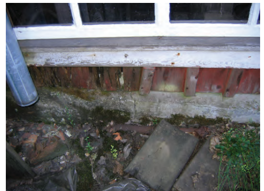
Kvarnens östfasad i vinkeln mot kraftstationen hade rötskador. Avvattningen från stupröret var bristfällig.
