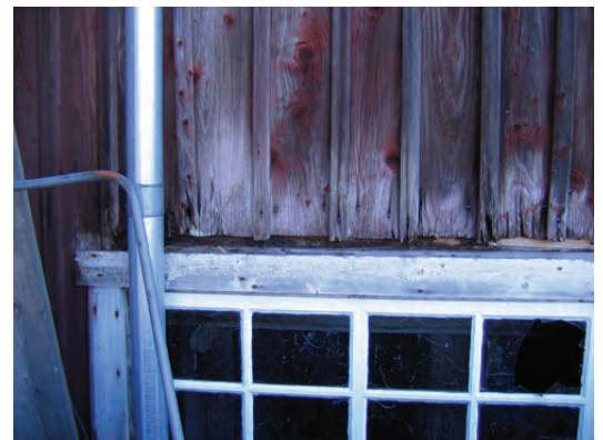
Dropplist saknades över flera av källarvåningens fönster.
