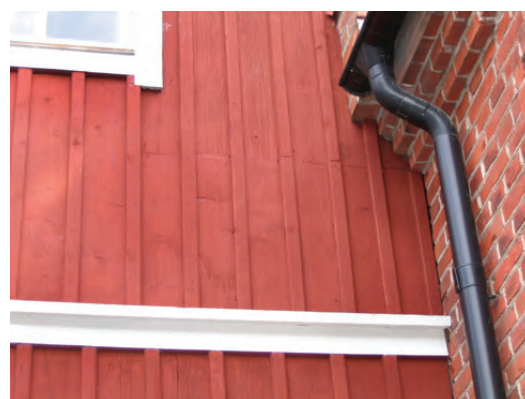
Ett parti med bytt panel ovan den horisontella listan och mot kraftstationen.
