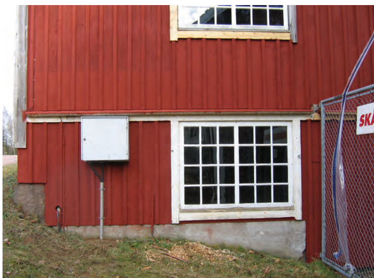
Sågens södra fasad. Elskåpet sänktes för att inte behöva bryta den horisontella listen. Partier med bytt panel kan anas som varande något ljusare, då ny panel inte suger på samma sätt som en gammal.
