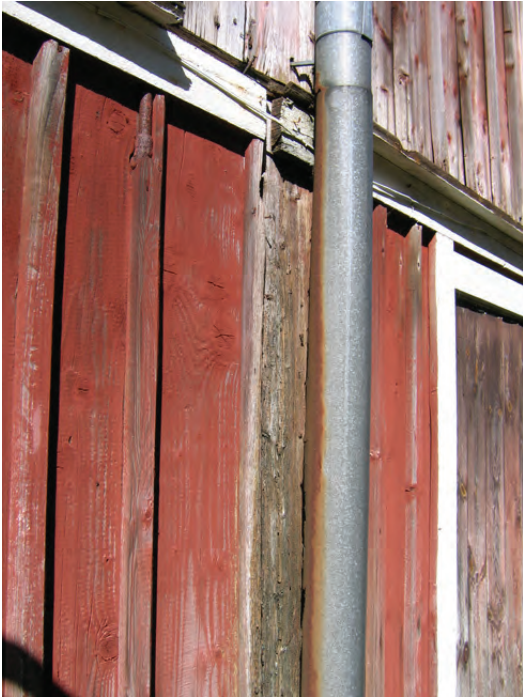
Stupröret på sågens södra fasad var sönderrostat, fasaden bakom var rötskadad och angripen av myror.
