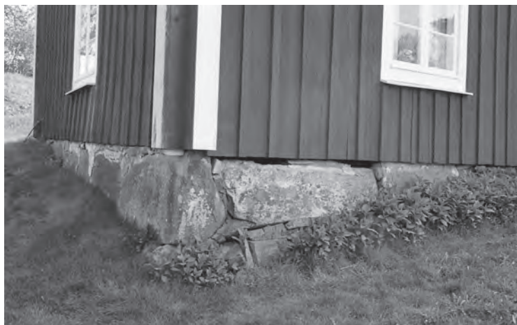
En sten i stenfotens sydvästra hörn hade sackat. Stenen före åtgärd.
