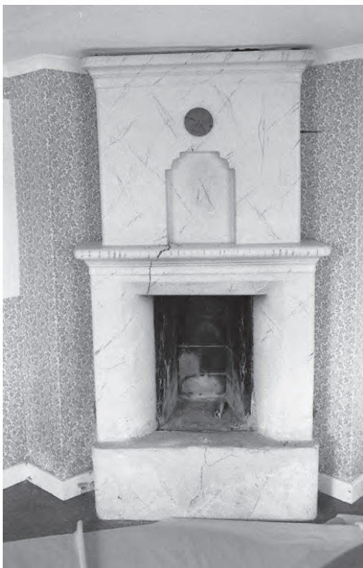
Rörspisen i kammaren före åtgärd.
