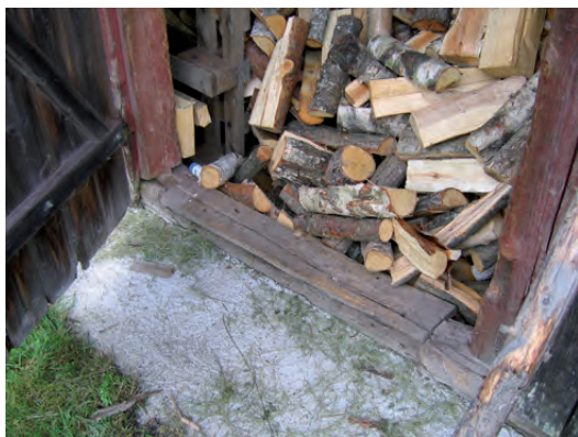
Skadad tröskel i vedboden.
