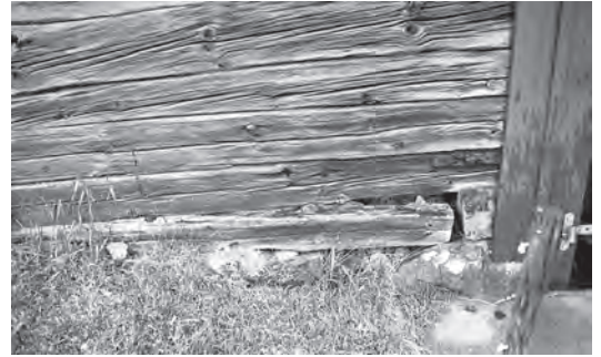
Vid dörrposten mot garaget hade det nedre timmervarvet dragits isär.
