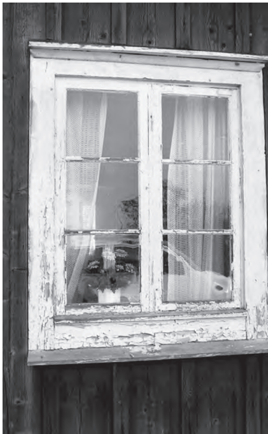
En av fönsterbågarna före åtgärd.
