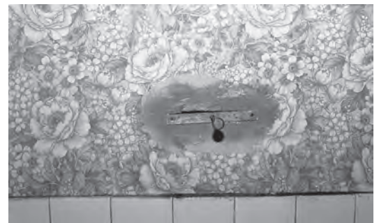
Putslagning vid spjället i köket.
