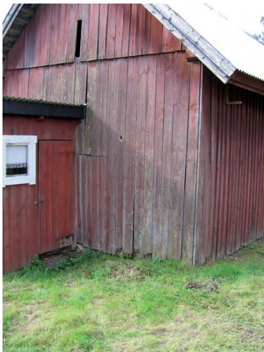
Vedboden och dasset före åtgärd.
