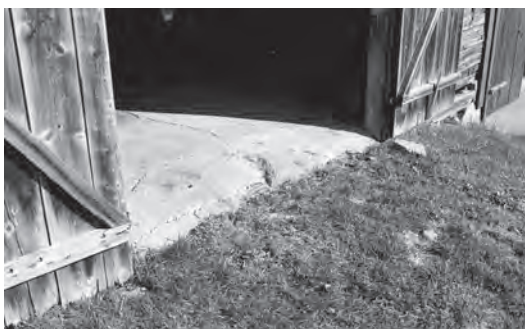
Bottensyllen i porten var skadad.
