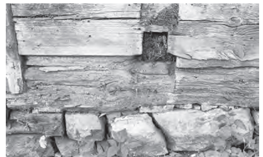
Bottensyllen av ek ser skadad ut, men var i gott skick.
