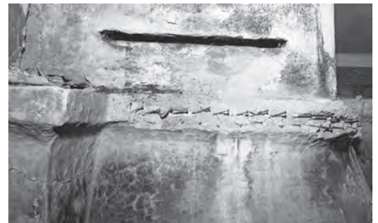
Den öppna spisen i kammaren på vinden hade bland annat skador på kransen.
