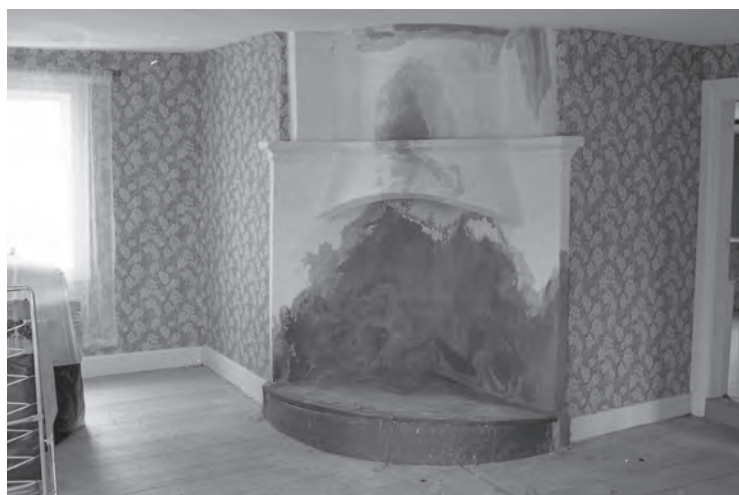
Till vänster: Den öppna spisen i salen vid slutbesiktningen i november 2003. Ovan: Vid efterbesiktningen, våren 2004, hade murstocken i stort sett torkat.
