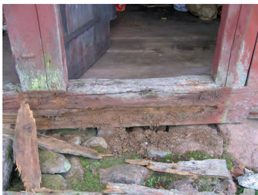
Rötskador vid tröskeln.
