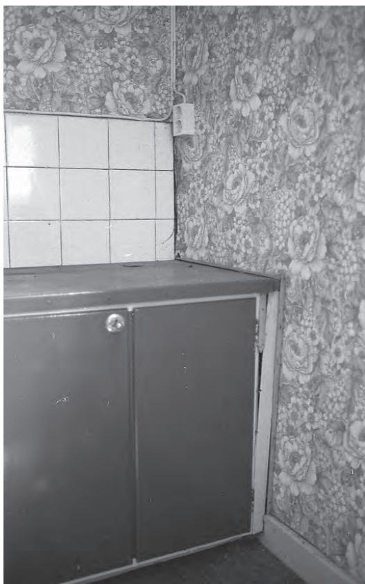
Vid köksinredningens möte mot väggen syntes tydligt hur sned yttervägen var.
