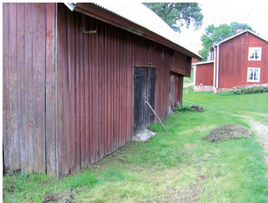
Vedboden före åtgärd.
