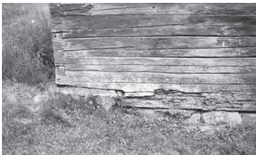
Rötskadorna i stommen var koncentrerade till marknivå.
