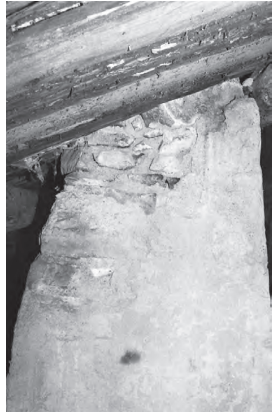
Ovan: murstocken hade skador på vind med putsbortfall upp mot taket.
