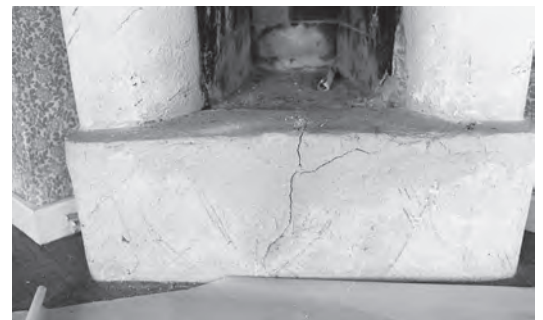
Rörspisen i kammaren hade sprickor bl.a. i sockeln.
