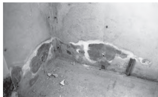
Fuktutfällning i muren i skrudrummet.
