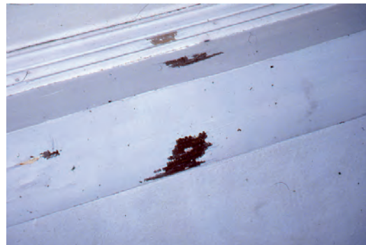
På takbjälkarna fanns spår efter äldre målningsskikt.
