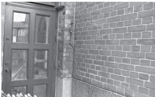
Åskledaren på norra fasaden var felaktigt monterad vilket ledde till fuktproblem i vapenhuset.
