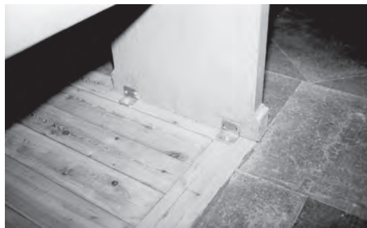
Vid slutbesiktningen påpekades att bänkbeslagen inte var innmålade.
