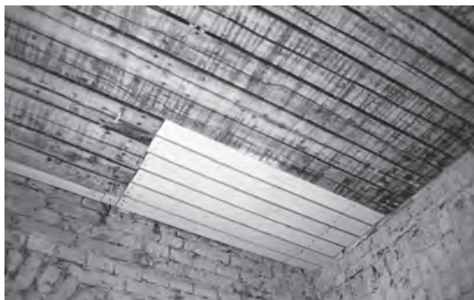
Lagad rötskada i takbotten i kapellet.
