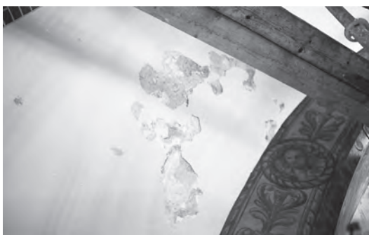
Putsskador mot valvbågen.
