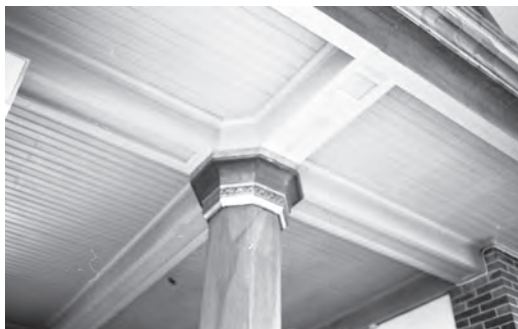
Taket under läktaren före åtgärd.
