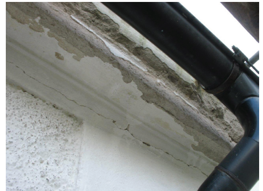
Putsskador på gesims i norr.
