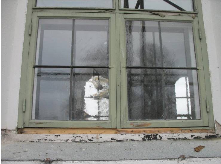
Fönster före ommålning. Stulet fönsterbleck av kopparplåt.
