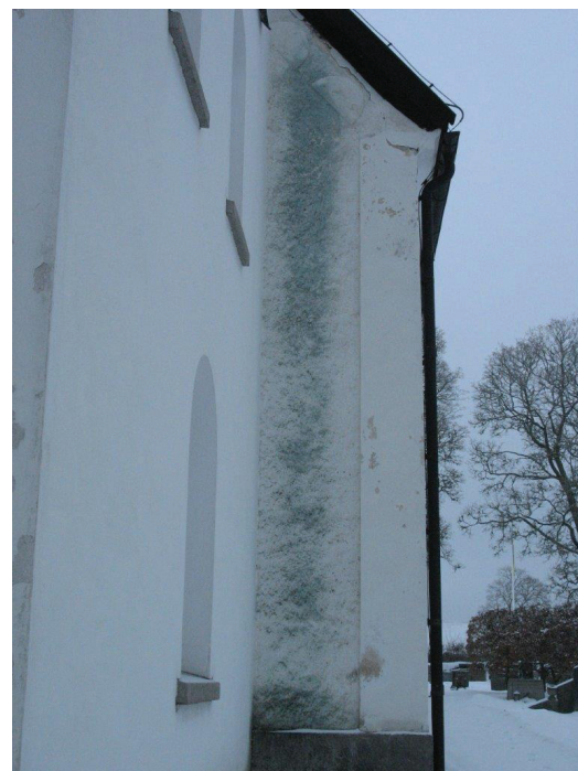
Puttskador och alger på västgavel.
