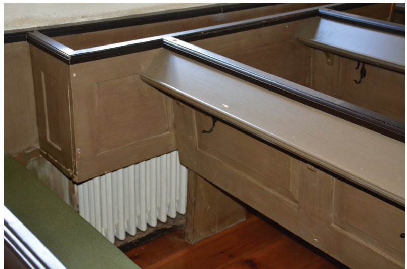
Kyrkorummet värms upp med vattenfyllda vägggradiatorer under fönstren.
