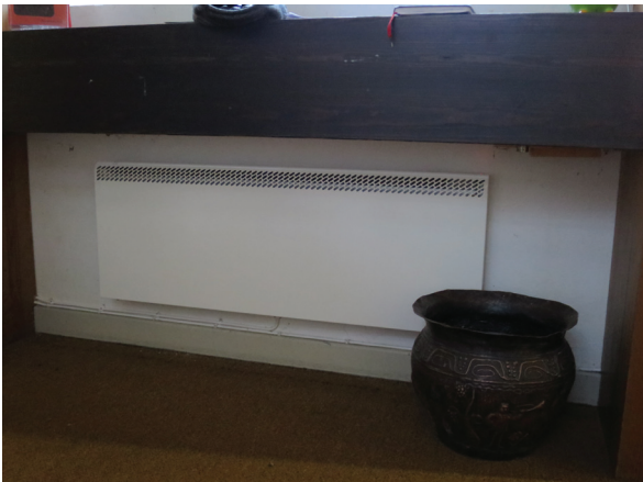
Kompletterande elradiator under fönstret i vapenhuset.
