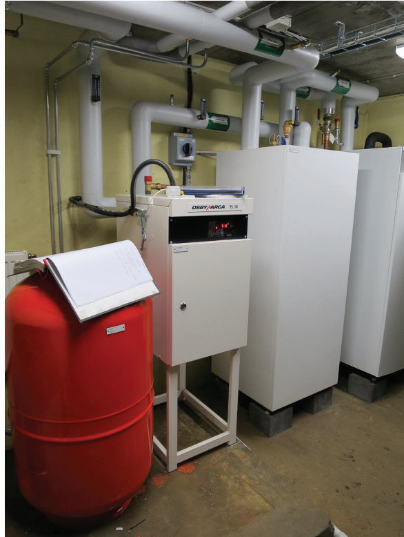
Ny bergvärmepump och elpanna i pannrummet.
