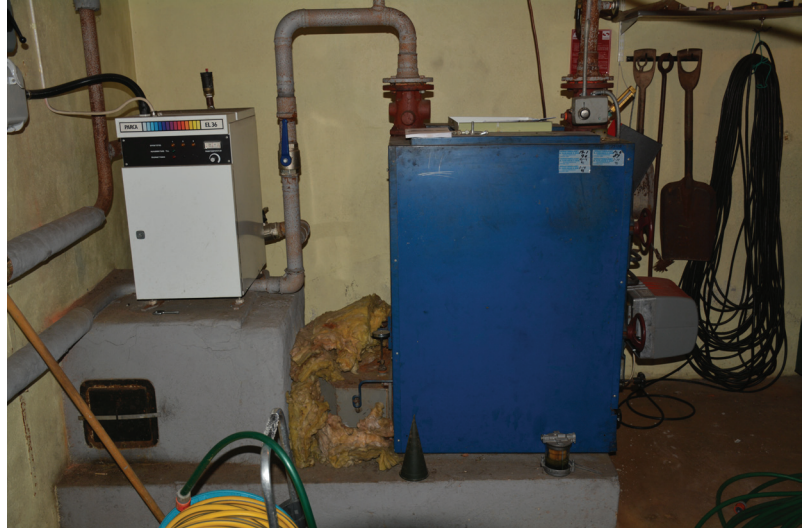
Befintlig oljepanna i pannrum.
