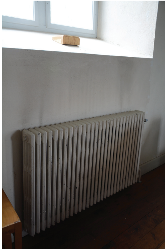
Kyrkorummets vattenburna radiatorer är vägghängda under fönstren.
