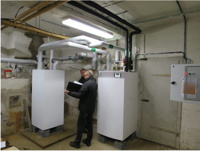
Pannrummet med ny bergvärmepump.
