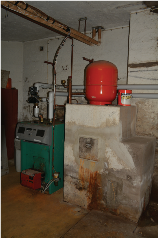
Pannrummet med befintlig oljepanna och den gamla anläggningen för lågtrycksånga.
