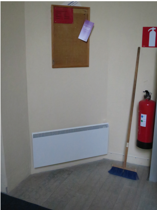
Kompletterande elradiator i vapenhus. Höljet skall målas in i väggkulör.
