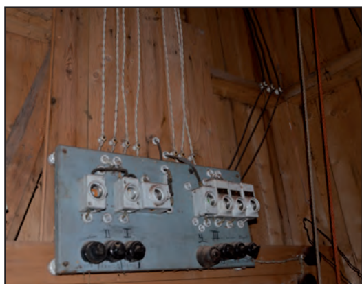
Teaterns elanläggning från 1926 har bevarats trots att ny el dragits in.
