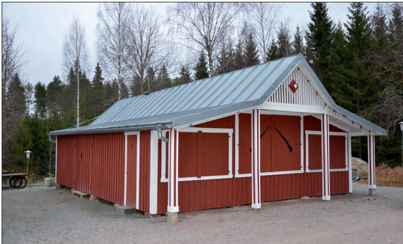
Skjutbanan från 1925 rustades 2011 upp efter att ha varit kraftigt förfallen. Den erhöll då en ny taktäckning med modern bandplåt, ett material som saknar historisk förankring i parken. Framsidans dekorativa stolpar har tyvärr även kortats av och dess socklar ersatts med OSB-skivor.
