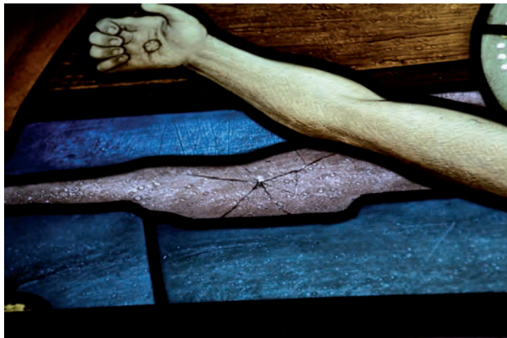
Exempel på skador. Sprucket målat glas.
