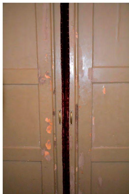
Pardörrar till ena vapenhuset med flagnande färgskikt från 1937. Ursprunglig plyschfodring.
