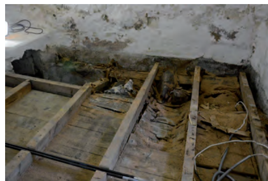
Det rötskadade bjälklaget från 1905 före rivning.
