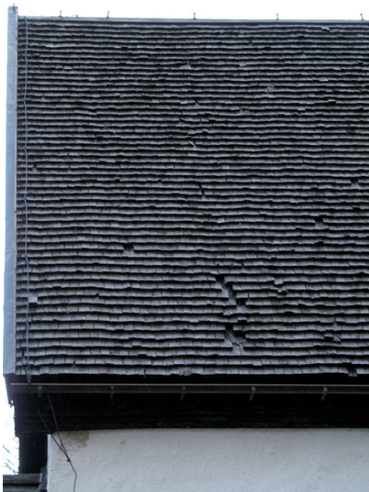
Det gamla taket med urfallna spån.
